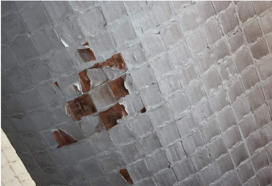
Fig. 68 | Desprendimiento pintura y cerámica. Foto: Manoel Seadi.
