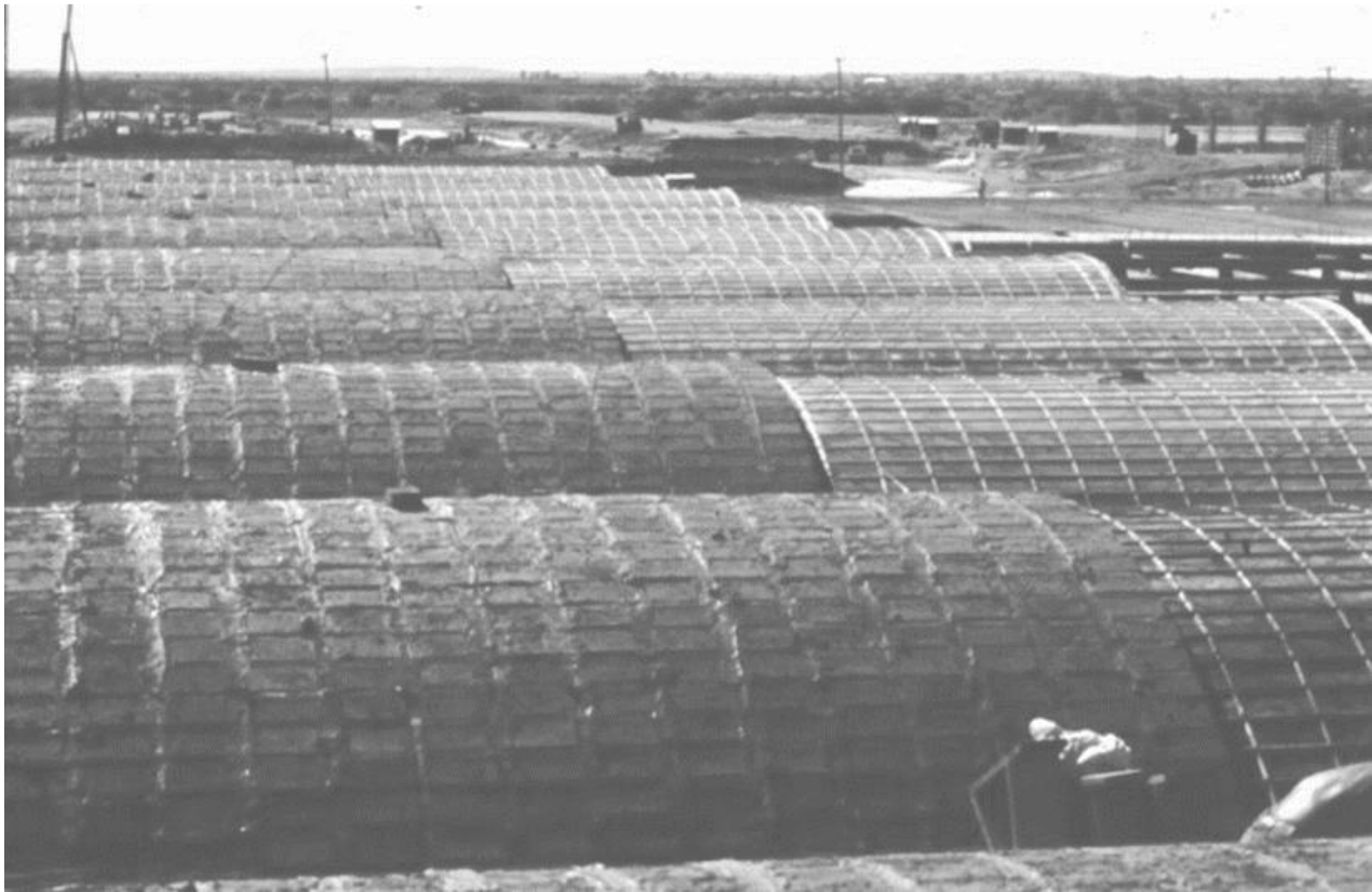
Fig. 54 | Puesta en obra de las bóvedas autoportantes de la CEASA/RS. Fuente: Acervo FAM.
