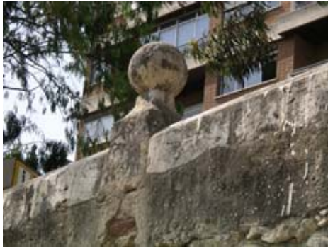
Erosión, suciedad contra negra en pretil y bolas decorativas.
