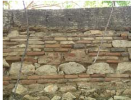
Actuaciones indebidas con ladrillo cerámico
