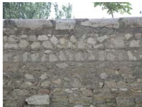
Rotura de sillares del pretil, parcheados con mortero de cemento.
