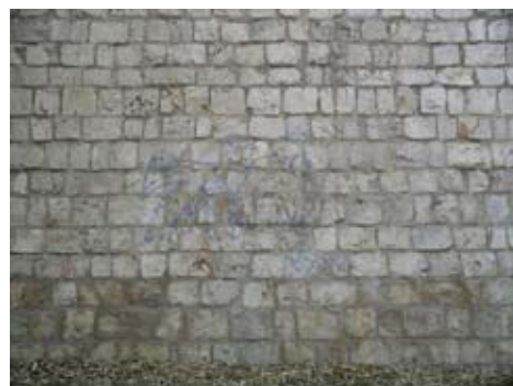
Humedades. Suciedad generalizada.
