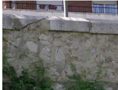
Rotura de sillar y parcheados con mortero de cemento.
