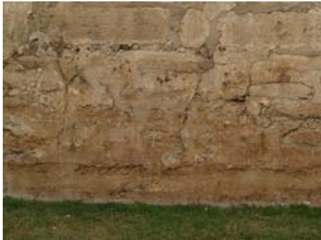
Perdida de sección útil en la parte baja del muro.
