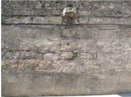
Disgregación de la parte baja del paredón. Cableado eléctrico recorriendo longitudinalmente el tramo.
