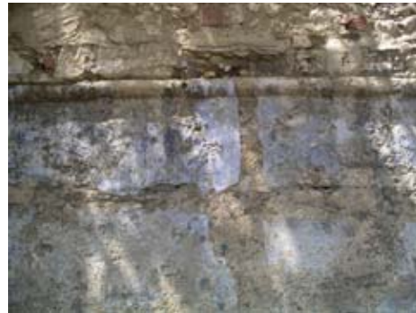
Restos de pintura de antiguas casetas adosadas a cauce
