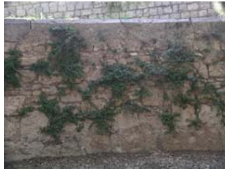
Vegetación superior en juntas. Suciedad generalizada.
