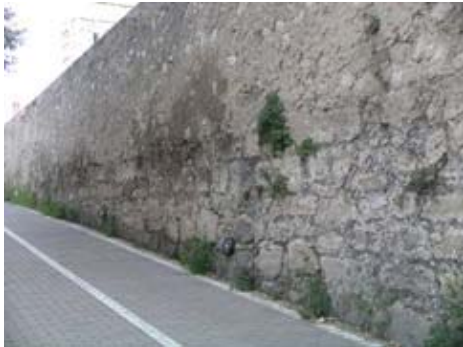
Humedades a media altura del paredón.
