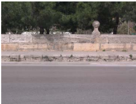
Suciedad con aparición de costra negra en pretil.
