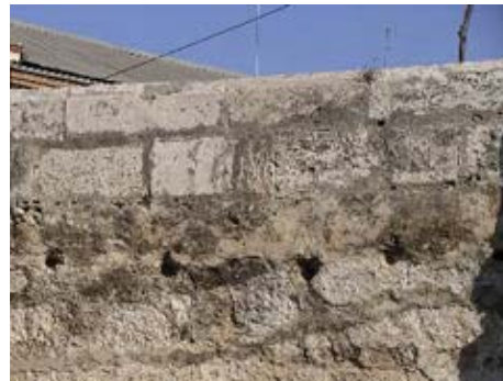
Suciedad, costras negras, parchados con mortero de cemento en pretil.
