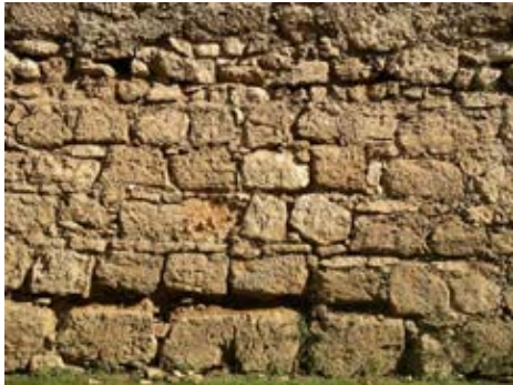
Falta de material conglomerante en juntas.
