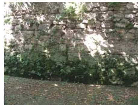
Humedades por capilaridad con aparición de musgo.
