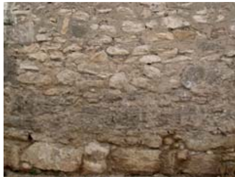
Falta de material conglomerante en juntas.
