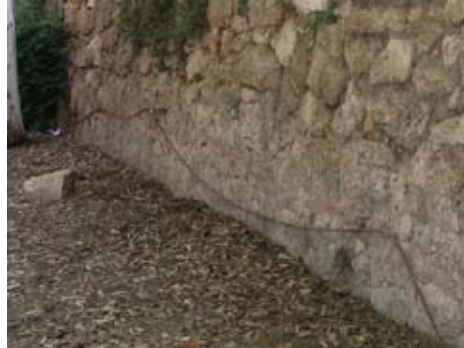
Cableado eléctrico recorriendo longitudinalmente el paredón. Erosión de la zona baja del muro.
