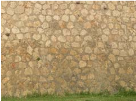
Humedades por capilaridad.
