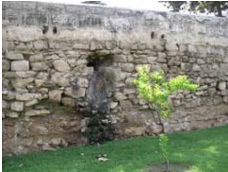
Disgregación - erosión generalizada, mas acentuada en la parte baja .
