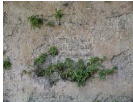
Disgregación del material de revestimiento.
