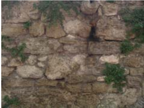
Falta de material conglomerante en las juntas.
