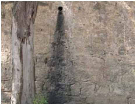
Desagües abandonados por el no uso
