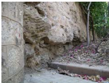
Erosión acentuada en la parte baja del paredón Pérdida de sección útil.
