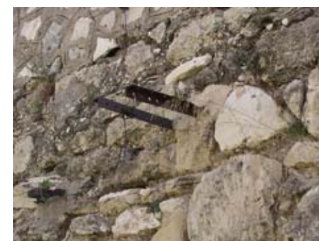
Restos de elemento metálicos oxidados.
