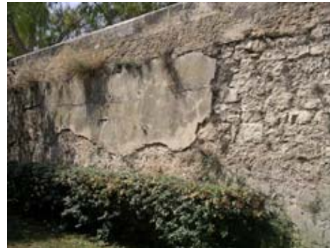
Restos de revestimientos de antiguas casetas decorativas.
