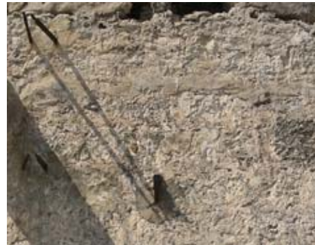
Restos de elementos metálicos oxidados. Parchados con mortero de cemento.
