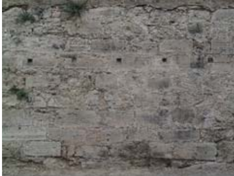
Perdida del material de revestimiento .
