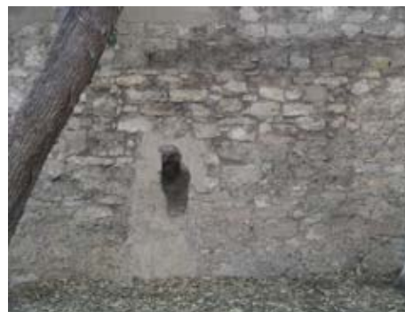
Huecos en el muro. Suciedad, costras negras en parte alta.
