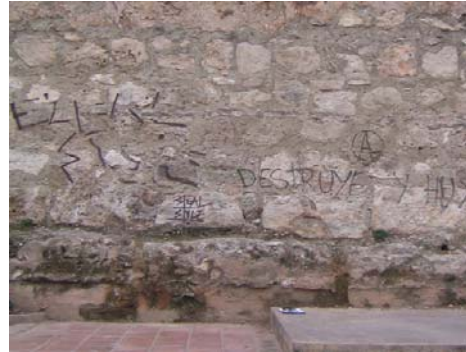
Humedad, aparición de musgo en parte baja, parte baja erosionada.
