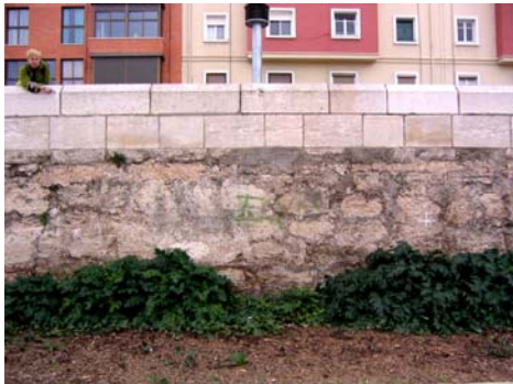
Parcheados y rejuntados con mortero de cemento. Graffiti, suciedad generalizada.
