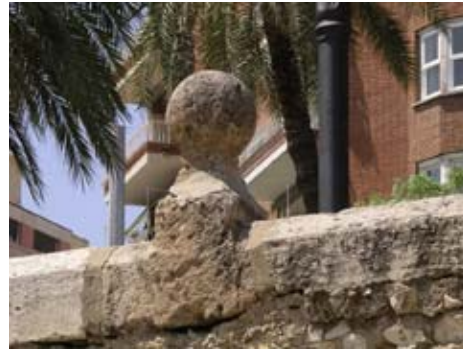
Bola erosionada, reparaciones con mortero de cemento.
