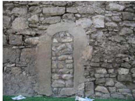
Huecos de antiguos desagües cegados con piedra y cemento.
