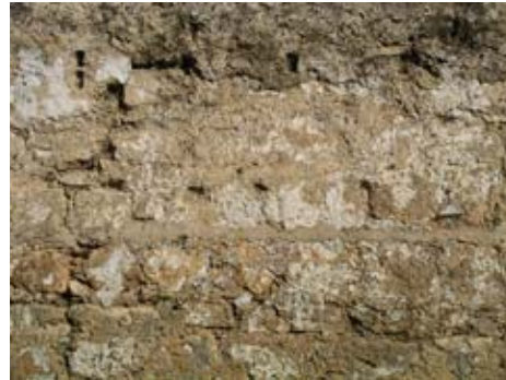
Restos de pinturas de antiguas casetas.
