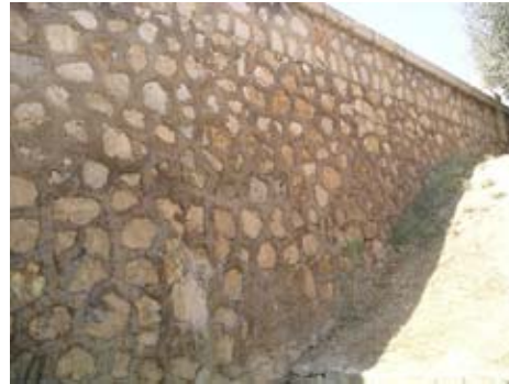
Humedades zona inferior.
