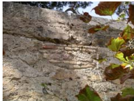
Reparaciones indebidas con ladrillo cerámico.
