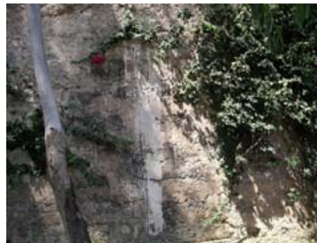
Manchas de pintura.
