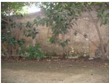
Humedad generalizada parte baja del paredón.
