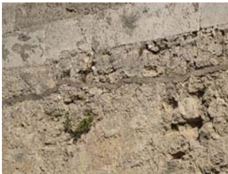
Roza longitudinal recorriendo todo el paredón con añadidos de mortero de cemento.
