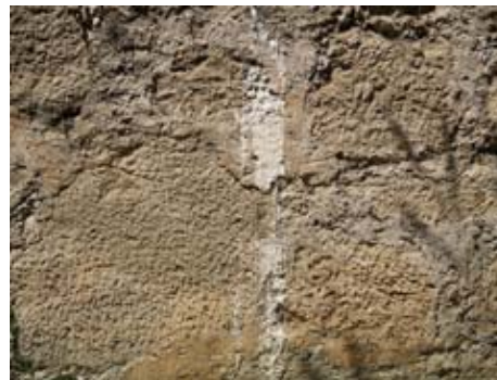
Manchas de pintura.
