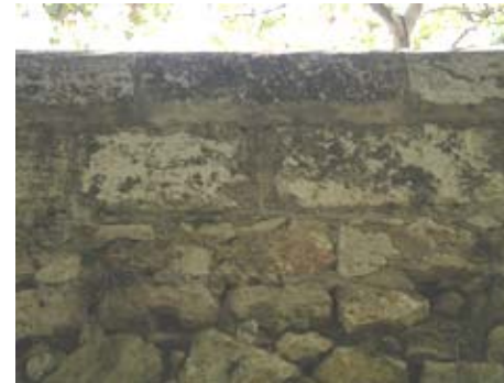
Rejuntados con mortero de cemento, suciedad, formación de costra negra, erosión.
