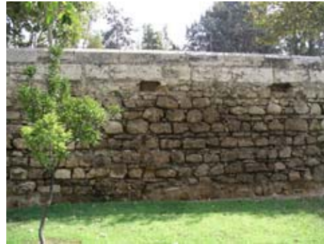
Humedad generalizada Falta de material conglomerante en juntas.
