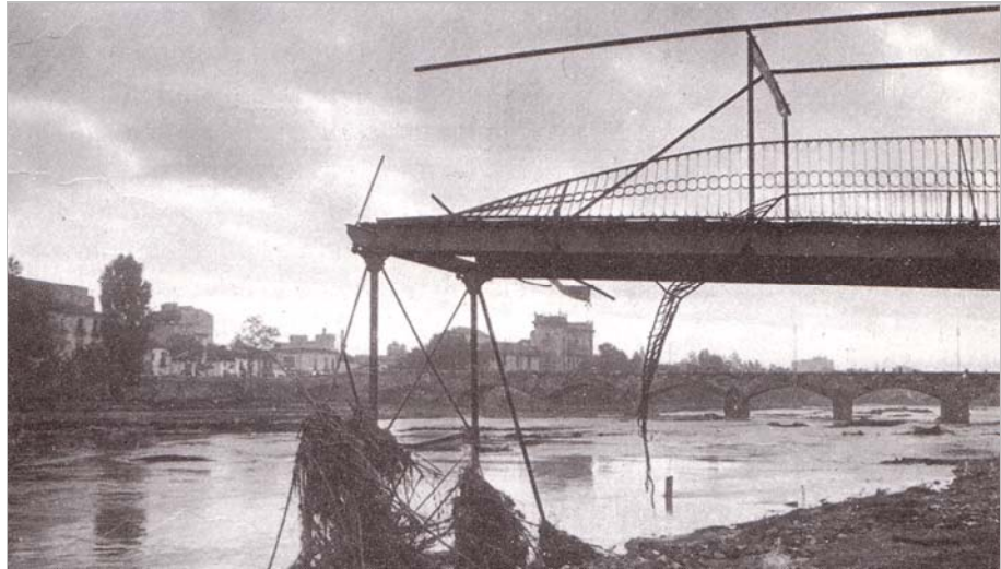
Estado del Pont de Fusta tras la riada acontecida en septiembre de 1949
