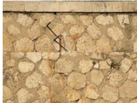
Restos de elementos metálicos oxidados y olvidados por el no uso.
