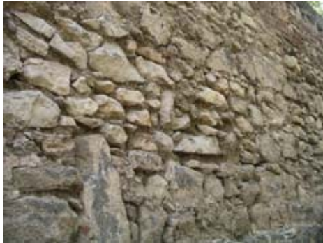
Falta de material conglomerante en las juntas
