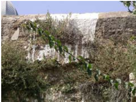
Manchas de pintura en pretil .
