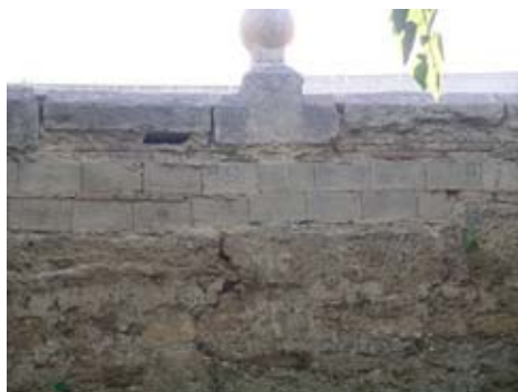
Actuación inadecuadas, reparación del pretil con bloque de hormigón.
