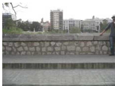
Suciedad generalizada en pretil.
