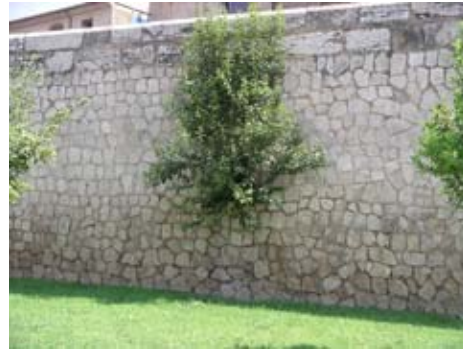
Humedad por capilarización generalizada. Vegetación superior.
