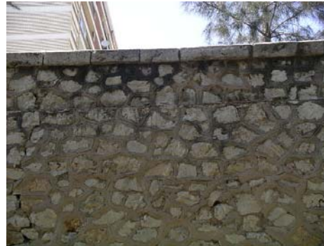
Suciedad generalizada, aparición de costras negras en la parte alta del muro.
