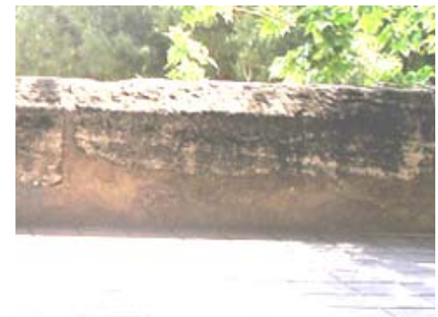
Pretil erosionado, suciedad generalizada. Formación de costras negras, rejuntados con mortero de cemento.
