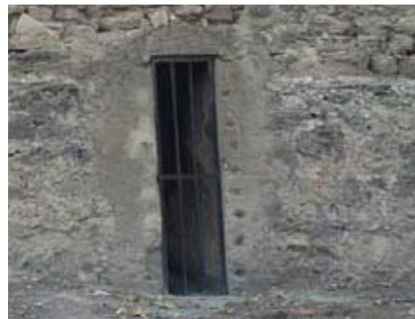
Aberturas en el muro y abandonadas por el no uso
