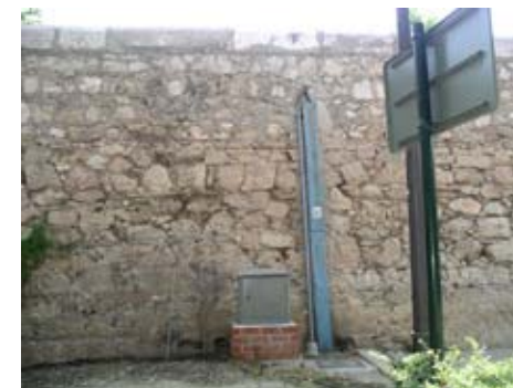
Cableado eléctrico insertado en el paredón.
