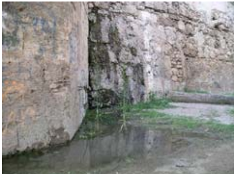
Rotura de canalizaciones de agua.
