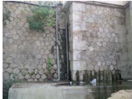
Canalización de agua rota, aportación continua de agua al muro, vegetación superior en juntas.
