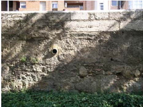
Antiguos desagües, parcheados con mortero de cemento.
