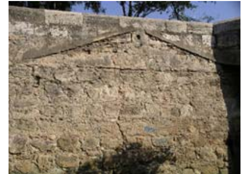
Restos de antigua caseta adosada al pretil.
