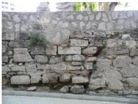
Pérdida de materia. Disgregación de las piedras, parcheados.
