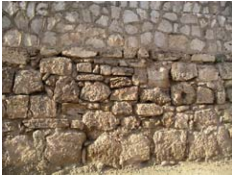
Falta de material conglomerante en juntas.
