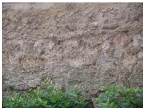
Disgregación de material de revestimiento.
