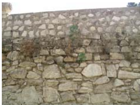
Vegetación superior en juntas. Falta de material conglomerante.
