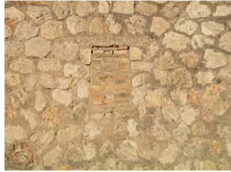
Reparaciones indebidas con ladrillo cerámico.
