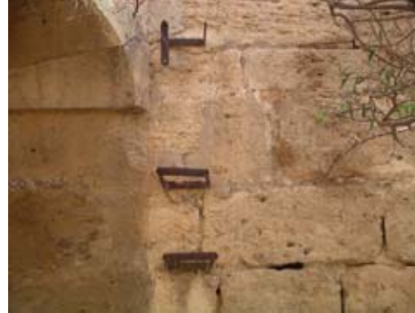
Restos de antiguas escaleras metálicas oxidadas
