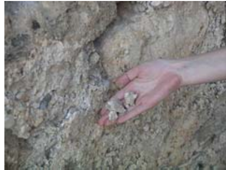
Disgregación de la piedra.
