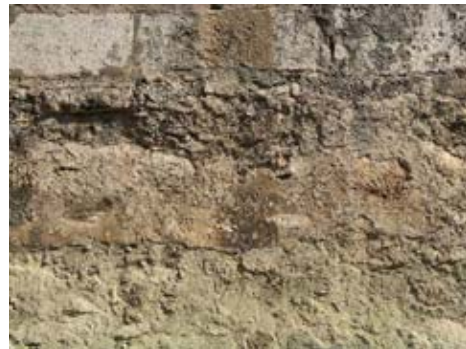
Disgregación, Costras negras.
