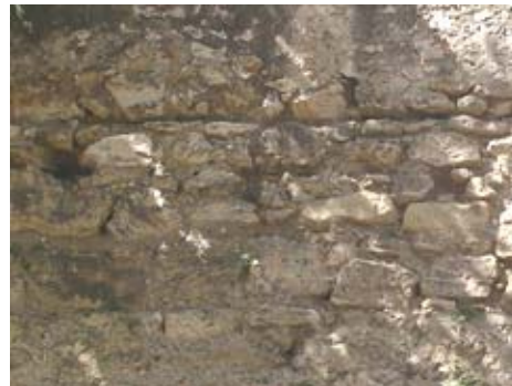
Falta de material conglomerante en juntas
