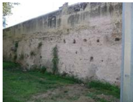
Disgregación del material de revestimiento. Suciedad generalizada, costras negras en pretil. Humedad zona baja del muro.
