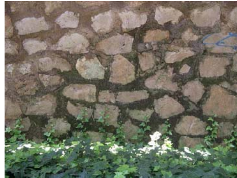
Humedades por capilaridad.
