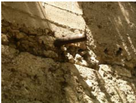
Antiguo desagüe abandonado por el no uso.
