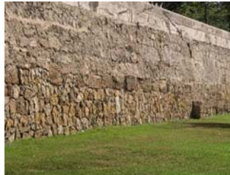
Humedades parte baja del paredón.
