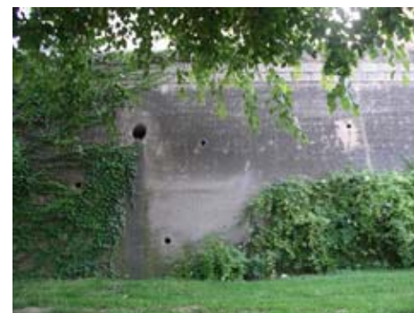
Actuaciones inadecuadas: trasdosado de parte del tramo con muro de hormigón armado.
