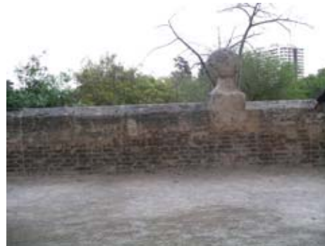
Suciedad generalizada en pretil.
