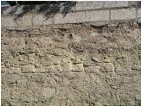
Disgregación del revestimiento.
