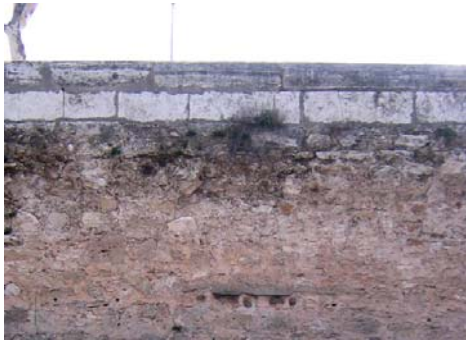
Pretil: Suciedad, vegetación superior en juntas Rejuntado con mortero de cemento, erosión.
