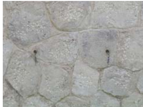
Elementos metálicos oxidados.
