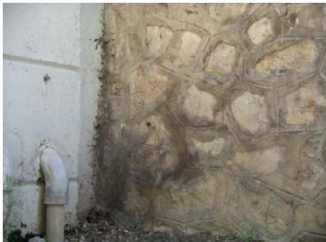
Humedad en las esquinas.
