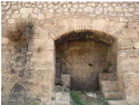
Suciedad generalizada, costras negras. Vegetación superior en juntas.
