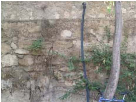
Canalizaciones de agua.
