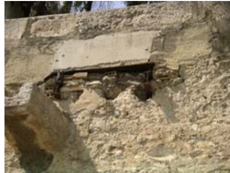
Actuaciones indebidas con mortero de cemento en juntas.
