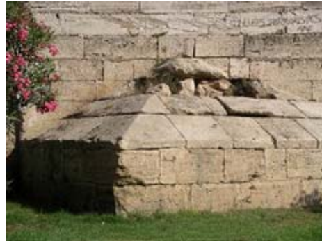
Rotura de sillares de la parte alta del estribo.
