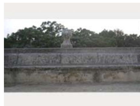
Bancos decorativos, suciedad generalizada formación de costras negras, parcheados con mortero de cemento
