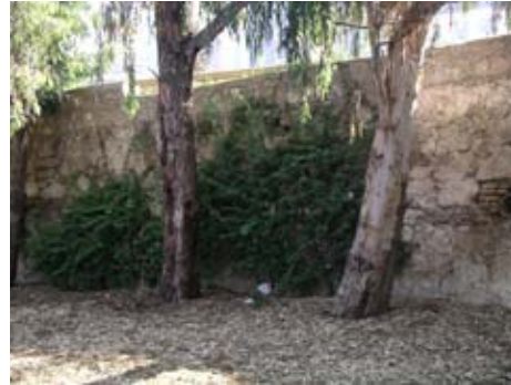
Vegetación trepante adherida al paredón.
