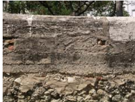
Costra negra, rejuntados con mortero de cemento.
