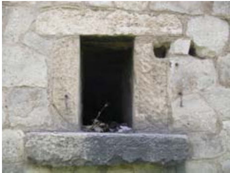
Antiguos desagües utilizados como vertedero de basura.
