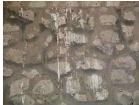
Restos de pintura.
