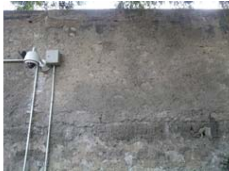
Alambros insertadas en el muro. Tramo revestido en su parte superior con mortero de cemento.
