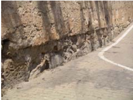
Erosión de la parte baja del paredón.
