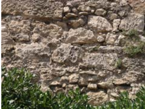
Falta de material conglomerante en juntas.
