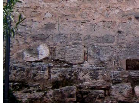
Humedad, costras negras, suciedad generalizada, falta de conglomerante en juntas,
