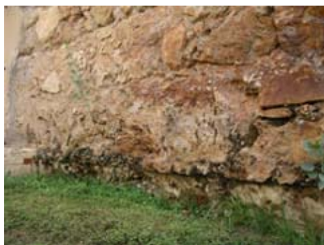
Humedad con formación de musgo.
