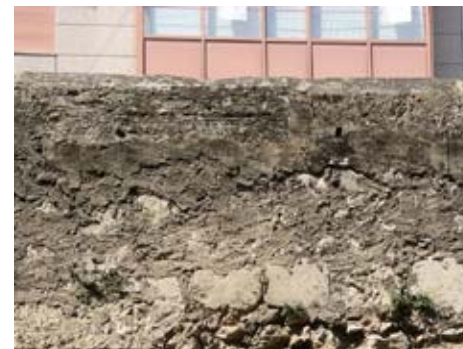
Suciedad, formación de costra negra. Parcheos con mortero de cemento.
