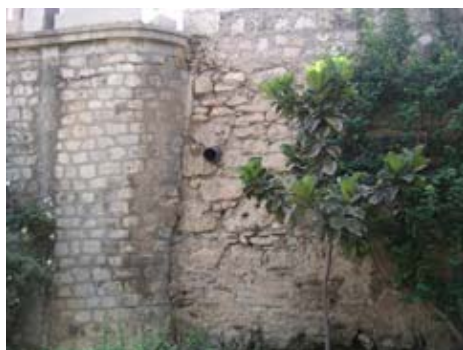
Falta de material conglomerante en juntas. Disgregación de material, suciedad. Vegetación lindante con el muro
