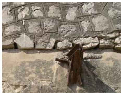
Restos de elementos metálicos oxidados
