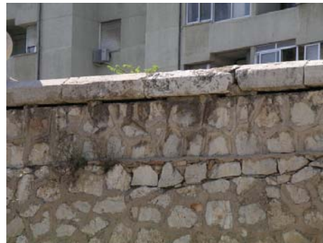
Falta de material conglomerante, vegetación en juntas.
