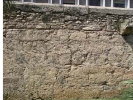
Suciedad generalizada en todo el tramo.
