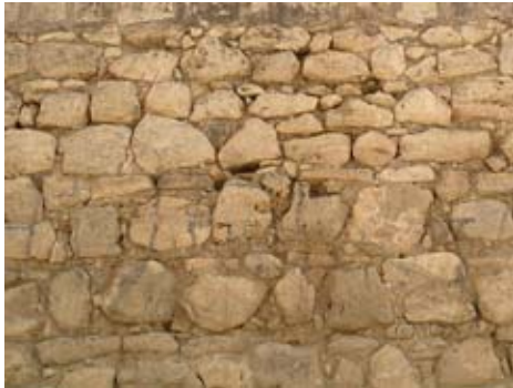
Perdida de material conglomerante en juntas.
