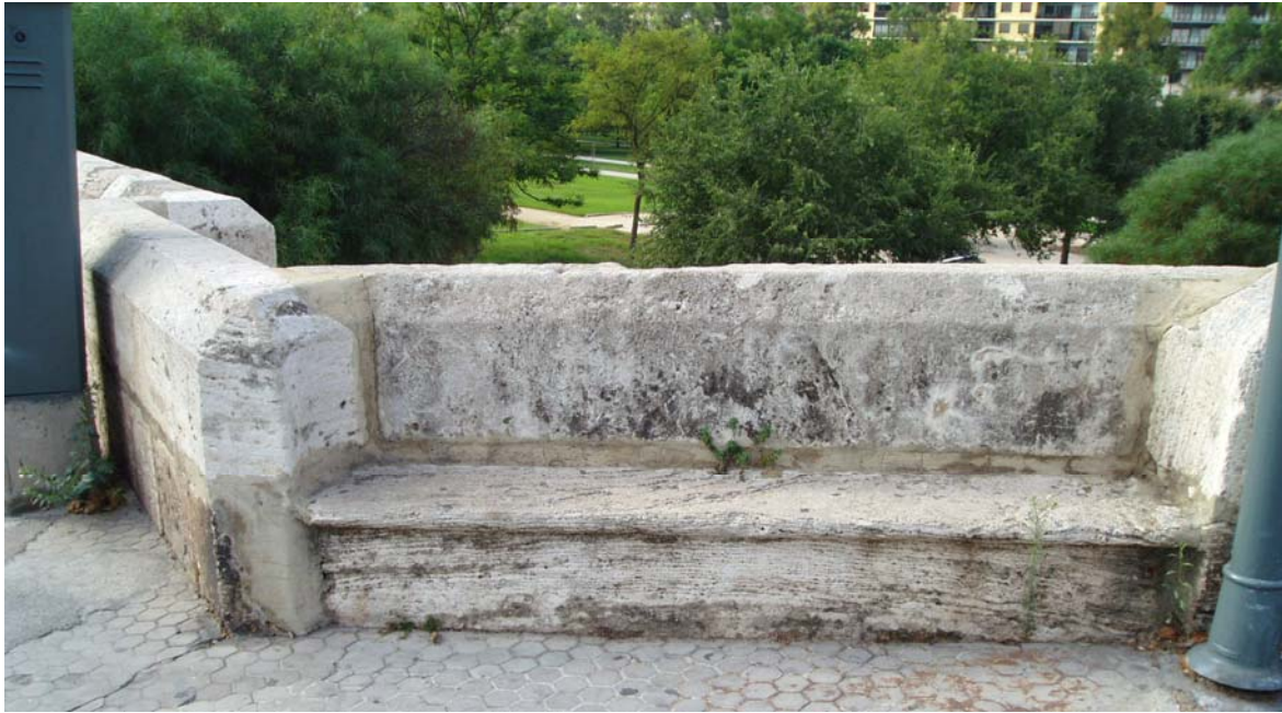
Banco de piedra en voladizo, unión del pretil del puente con el pretil frente a la calle San Pio V.
