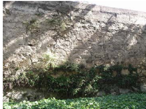
Humedades zona inferior. con aparición de musgos, líquenes....
