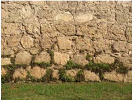
Vegetación en juntas, en parte baja del paredón.
