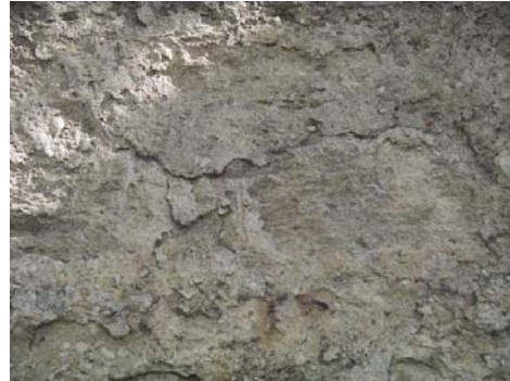
Disgregación del revestimiento.
