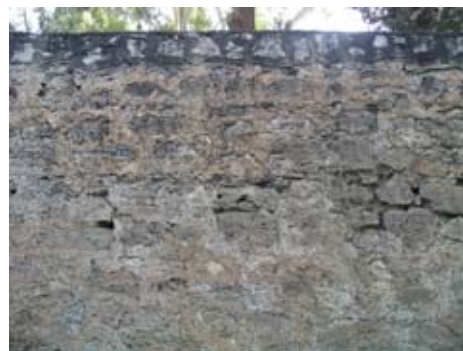
Rejuntados con mortero de cemento. Suciedad generalizada, formación de costras negras.
