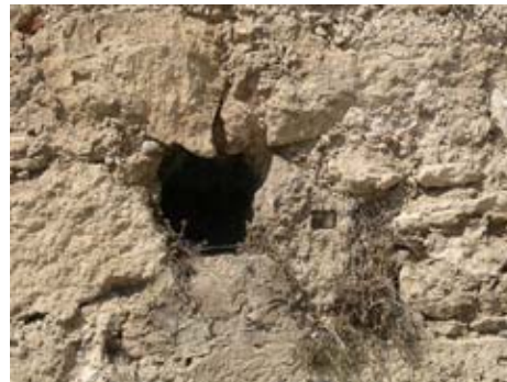
Huecos en el paredón.
