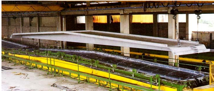
2.14. Elevación por medio de puentes grúa, Ref. Prevalesa
