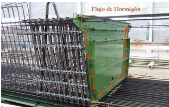
2.1. Flujo de hormigón en el vertido de vigas en U, Ref. Prevalesa
