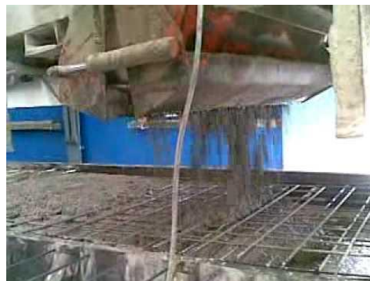
14.62 Posible disgregación por excesiva agua en la dosificación
