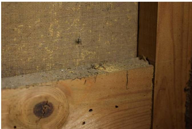
Fig.23. Acumulación de polvo en el bastidor
