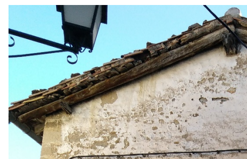
[Fig. 3.045] Fotografía deformación detalle 1. Fuente: <E. Ripollés>.
