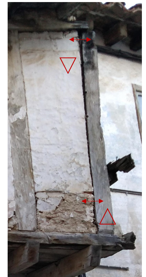
[Fig. 3.049] Fotografía fisuración detalle 13 y 13.1. Fuente: <E. Ripollés>.
