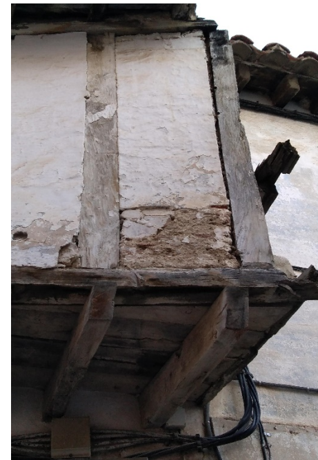
[Fig. 3.044] Fotografía deformación detalle 11. Fuente: <E. Ripollés>.
