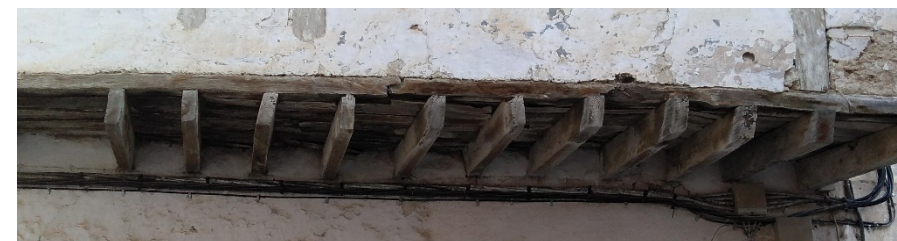
[Fig. 3.047] Fotografía deformación detalle 6. Fuente: <E. Ripollés>.
