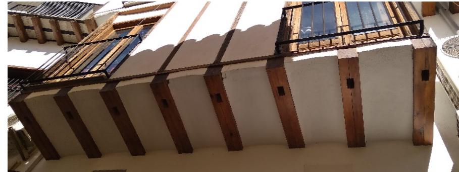
[Fig. 2.153] Fotografía detalle, Callejón de Fortea 4-6, viguetas sin refuerzos. Fuente: <E. Ripollés>.
