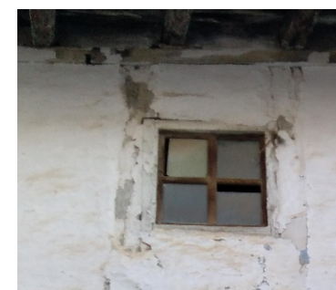
[Fig. 3.046] Fotografía deformación detalle 8. Fuente: <E. Ripollés>.
