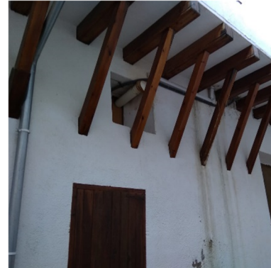
[Fig. 2.152] Fotografía vivienda callejón de la Presó 13, viguetas con refuerzos de madera. Fuente: <E. Ripollés>.
