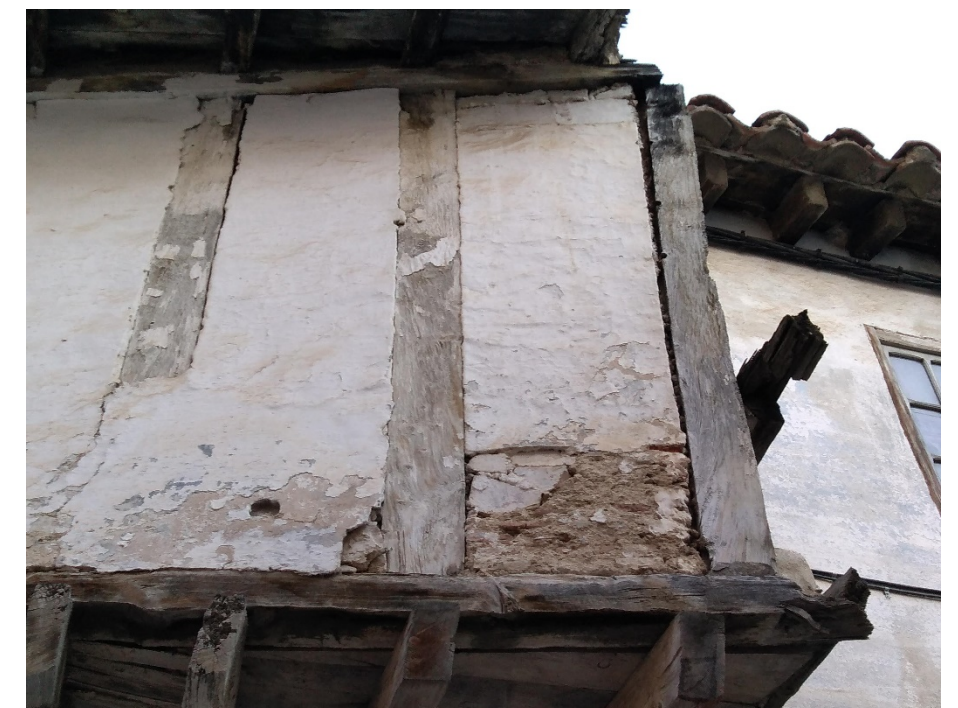
[Fig. 3.013] Fotografía detalle fachada de lajas de piedra y montantes de madera, Vivienda Virgen del Rosario, 28. Fuente: <E. Ripollés>.
