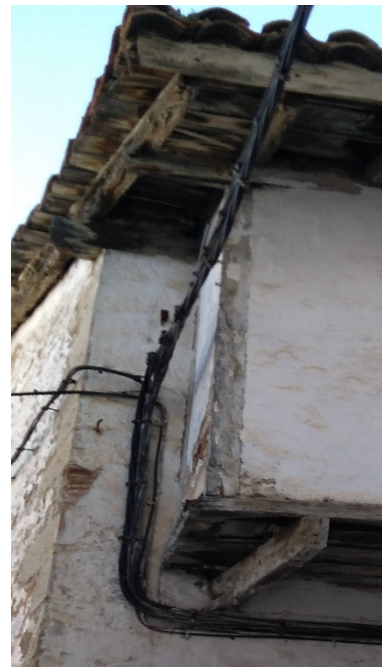
[Fig. 3.043] Fotografía deformación detalle 5. Fuente: <E. Ripollés>.
