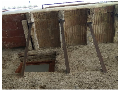
[Fig. 2.151] Fotografía detalle, Callejón de la Presó 19, viguetas con refuerzos metálicos. Fuente: <E. Ripollés>.
