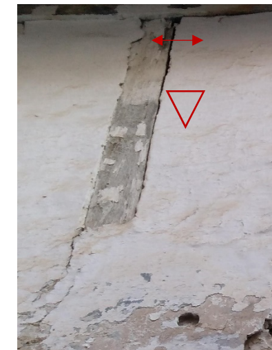
[Fig. 3.048] Fotografía fisuración detalle 12. Fuente: <E. Ripollés>.
