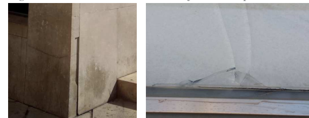
Figura 168. Agrietamiento horizontal de aplazado, y agrietamiento del alabastro.
