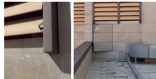
Figura 167. Lamas cerámicas rotas y falta de aplazado.
