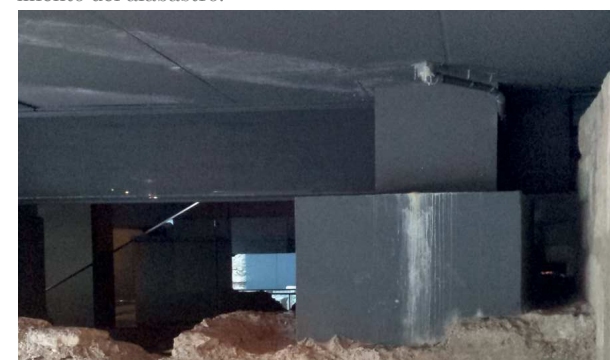
Figura 169. Estalagmitas en el techo por filtraciones de agua.
