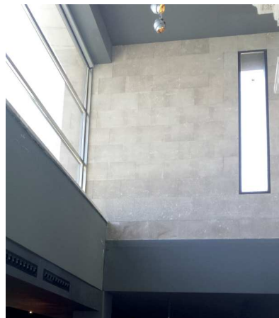
Figura 147. Vista rasgadura y fachada del edificio secundario.
