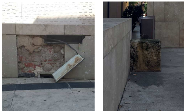
Figura 163. Iluminaria arrancada, ausencia de aplacado de piedra caliza, y orines.
