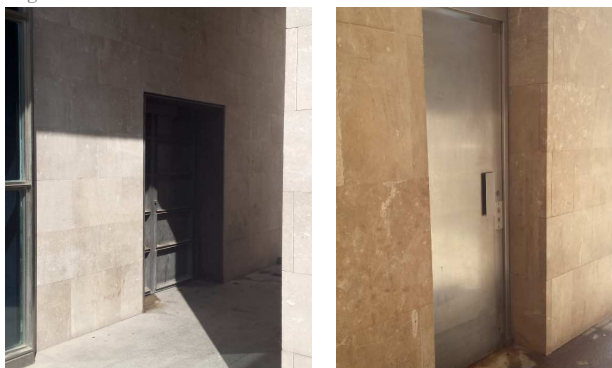
Figura 109. Puerta de acceso y del ascensor. Edif. Secundario.
