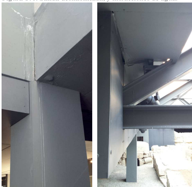
Figura 171. Desconchamientos por las filtraciones de agua.
