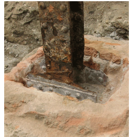
FIGURA 18: Base de pilar con graves corrosiones.
