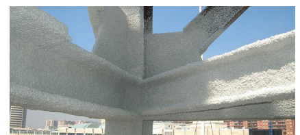
FIGURA 24: Protección anti incendios de varios perfiles.
