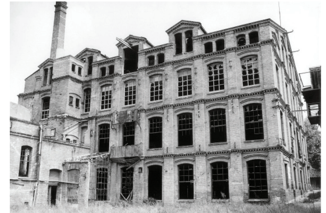
IMG 81: Estado de la Nave A anterior a la intervención
