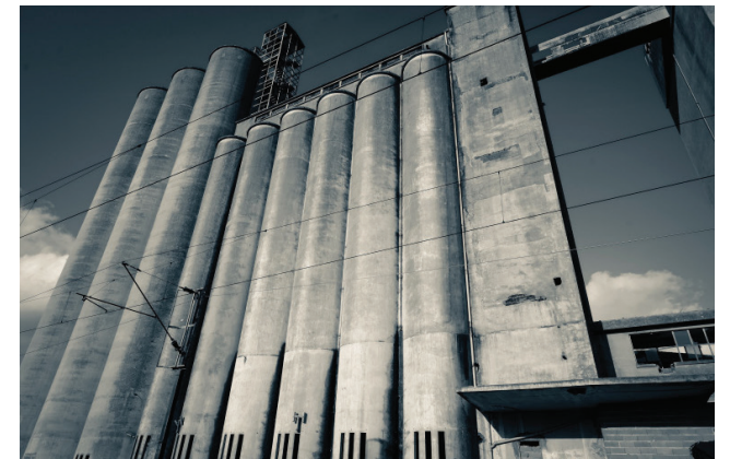
IMG 3: Edificación industrial en estado de deterioro y/o Abandono
