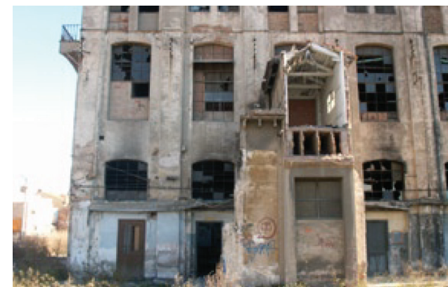
IMG 83: Estado de la Nave A anterior a la intervención
