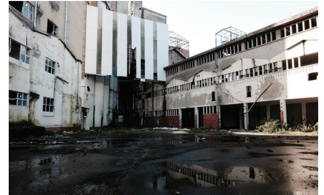
IMG 3: Edificación industrial en estado de deterioro y/o Abandono
