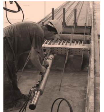
Fig. 72 Maquinaria de tensado.
