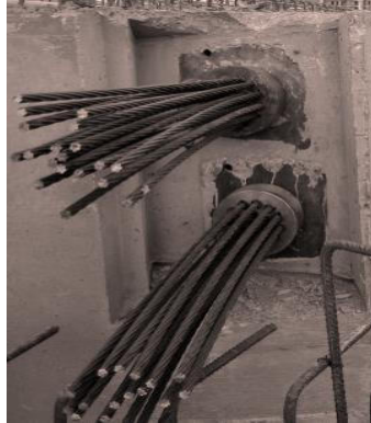
Fig. 25 Elemento de hormigón postesado.
