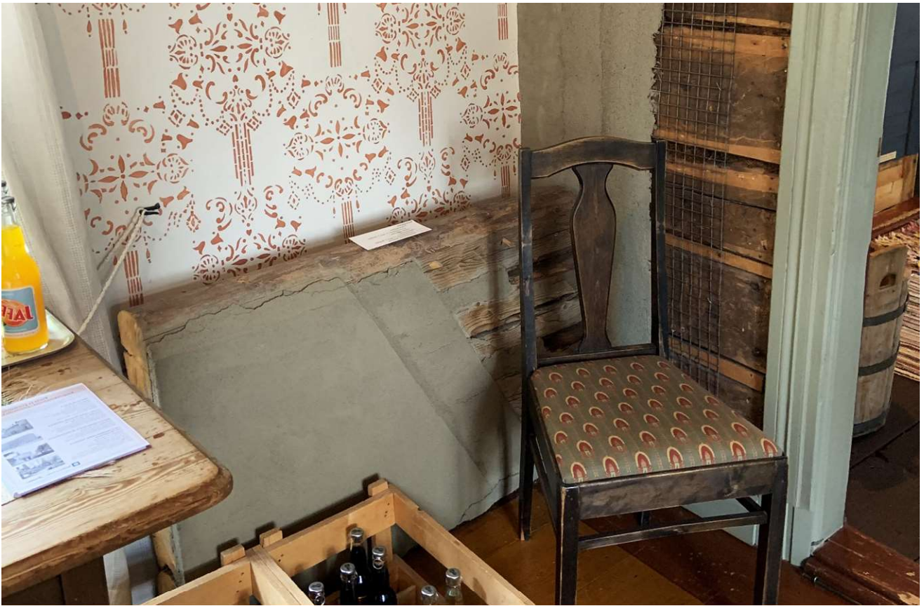
Figura 74: Enlucido tradicional con mortero de tierra en Toivo. Se pueden apreciar los dos diferentes sistemas, con rejilla o directamente sobre los troncos. (f.d.a. 18/09/2019)
