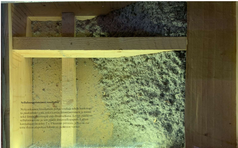
Figura 88: Forjado moderno con una base inferior en forma de tablero, un doble sistema de rastreles y fibra de celulosa. Aunque el sistema sea un poco diferente, cabe destacar que los materiales empleados son los mismos que en los casos anteriores (f.d.a. 18/08/2019)
