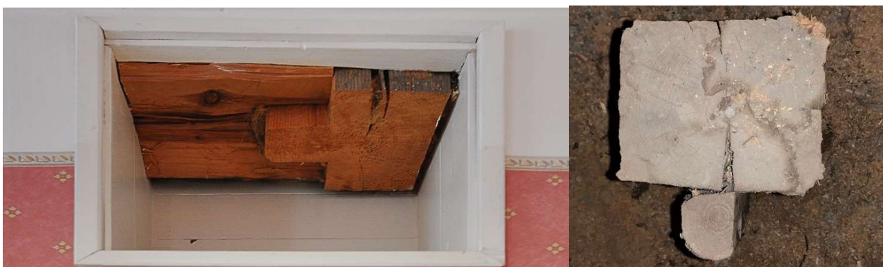
Figura 96: Sistema de unión entre muro de ladrillo y troncos; elemento que sobresale en el forjado de los bajo techos (f.d.a. 30/09/2019)
