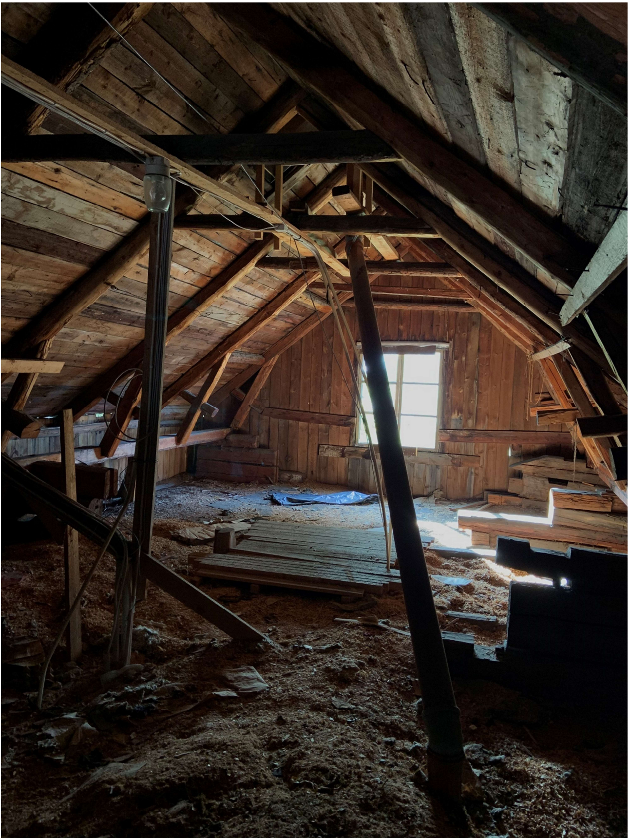
Figura 99: Bajo cubierta de Tammela, ala oeste. En muchas viviendas se aprecian variaciones al sistema: en este caso los elementos de refuerzos no apoyan en el piso, sino que el horizontal está sujeto en las extremidades por troncos de madera y queda separado del suelo. Esta modificación se remonta, probablemente, a los cambios sufridos por el edificio, no solo a su ensanchamiento sino también a intervenciones de recredido en altura. (f.d.a. 27/09/2019)
