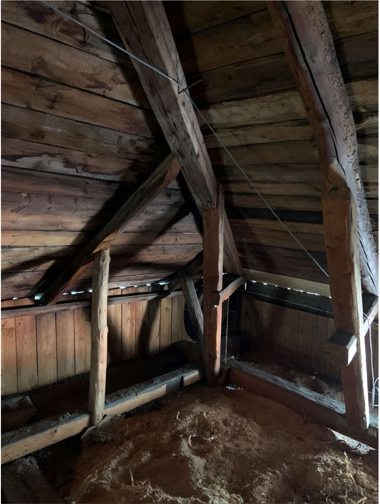
Figura 100: Bajo techo de Tammela, detalle del encuentro en la esquina noreste. En esta parte del edificio los elementos de soporte apoyan en una viga del piso, pero existen muchas irregularidades, debidas a cambios y reformas. (f.d.a 27/09/2019)
