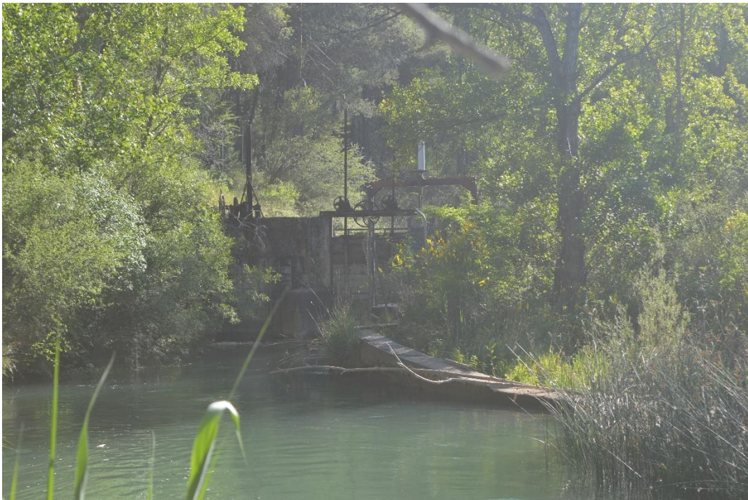
Figura 71. Compuertas de la toma de la central hidroeléctrica Las Grajas
