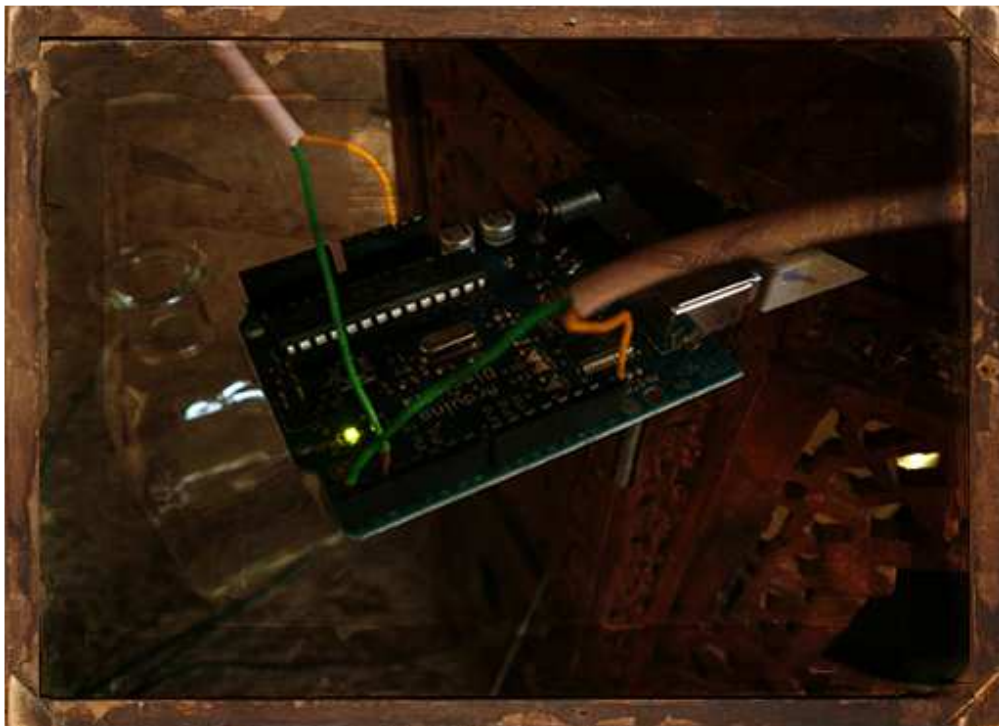
Figura nº 58: Conectando RFID a Arduino en la instalación (Arduino+RFID)
