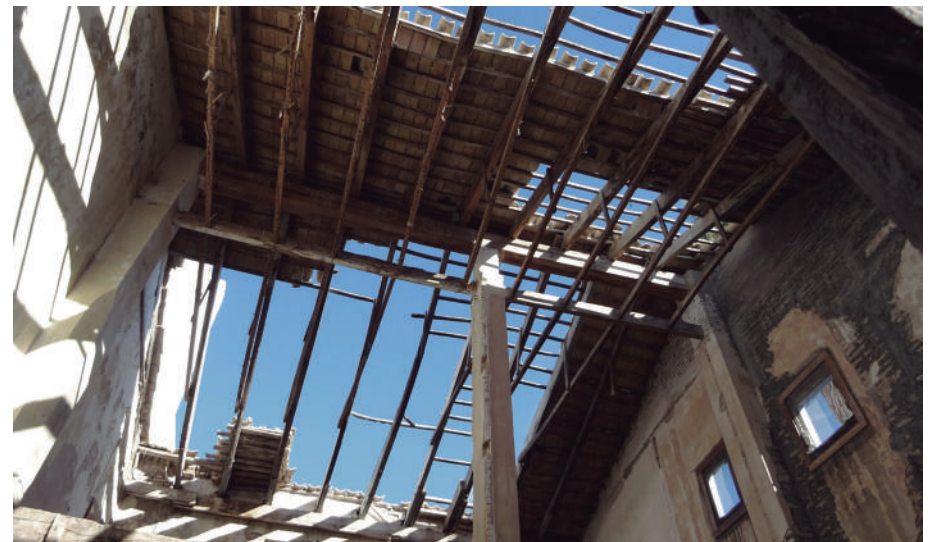
[Fotografía de Andreu Climent]. (El Palmar, 2017). Vista interior del estado del tejado de la tercera pieza de la Trilladora del Tocaio.
