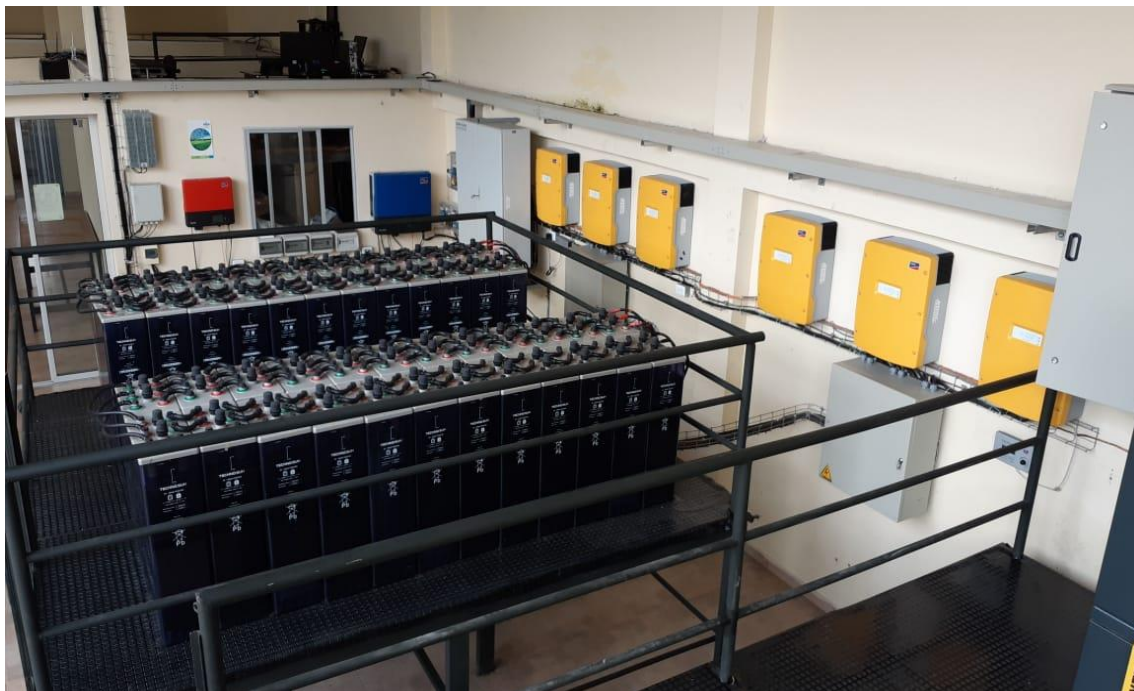
Figura 1.5. Sistema de almacenamiento de energía en baterías. LadER - Andagoya (Chocó).
