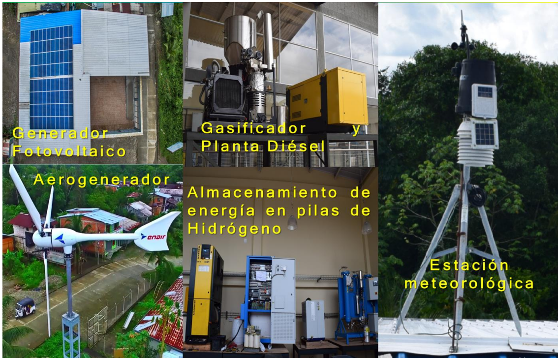
Figura 1.4. Equipos instalados en el LadER – Chocó.
