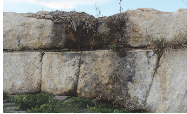
Figura 13. Pérdida de agua.
