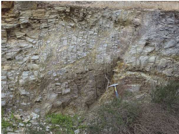
Figura 6. Estratos rocosos bajo una torre en el lado Noreste. Trituración de la masa rocosa y presencia de una falla.
