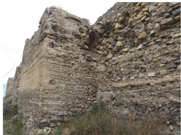
Figura 3. Cara Suroeste del Castillejo. Muros de tapia de calicanto. A simple vista se aprecian las tongadas y en las zonas donde se ha desprendido la costra se observan las hiladas de mampuestos.
