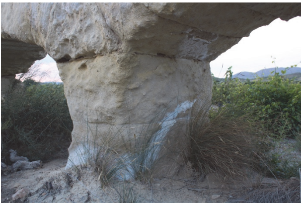
Figura 11. Eflorescencias en la base.
