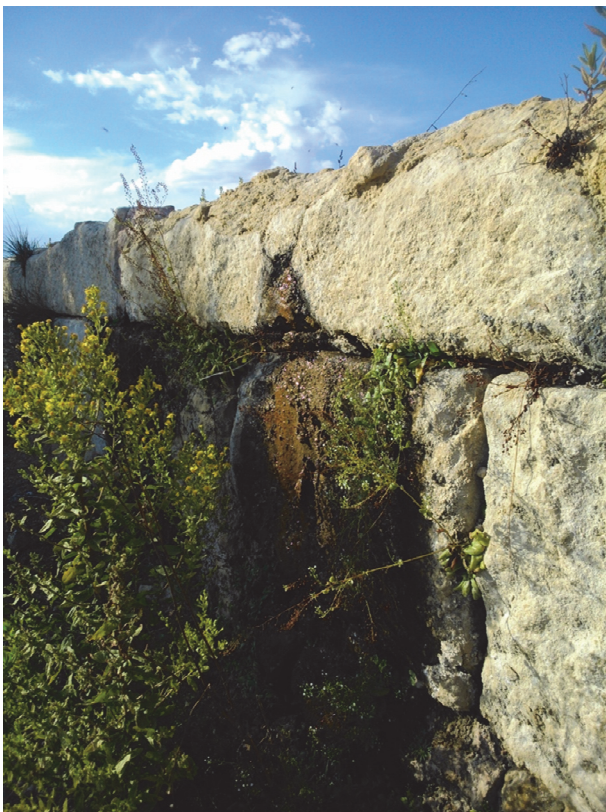
Figura 12. Crecimiento de plantas y musgos en las fisuras.
