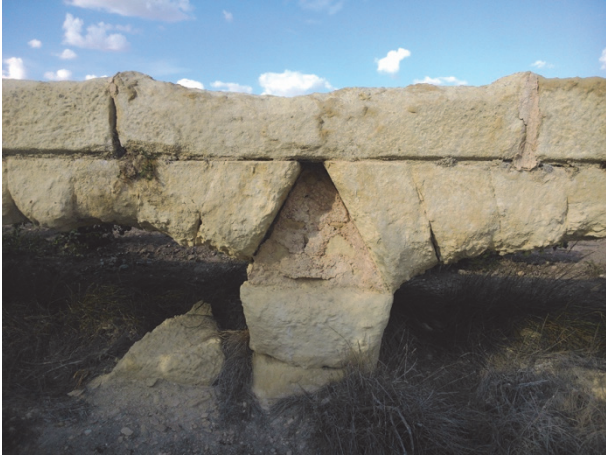
Figura 10. Erosión y desprendimiento.
