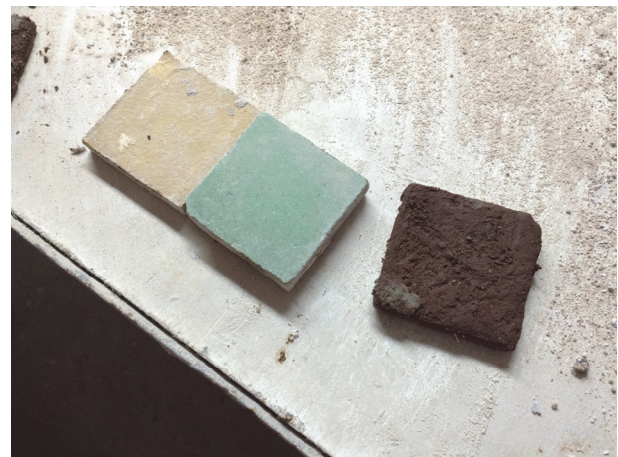
Figura 3. Imagen donde se aprecia la corrosión por ácido en las teselas de imitación (2014).
