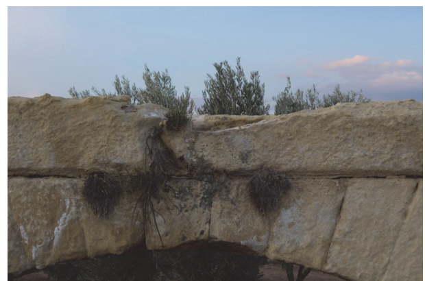
Figura 9. Erosión y crecimiento de flora
