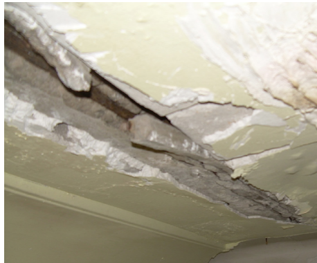
Figura 40. Patologías de corrosión y desprendimiento del hormigón. Vivienda puerta número 9.
