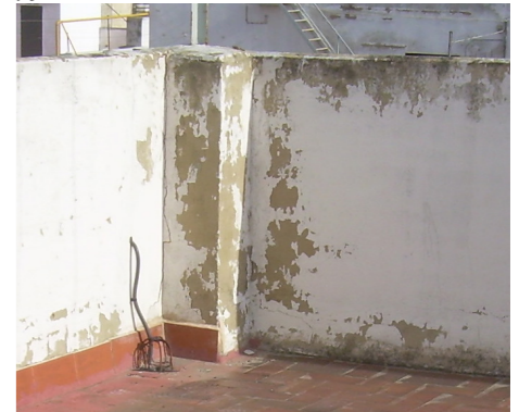
Figura 25. Patología de pérdida de cohesión. Antepecho cubierta comunitaria.
