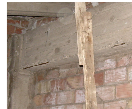
Figura 36. Desprendimiento del hormigón en viga. Salón vivienda puerta número 19.
