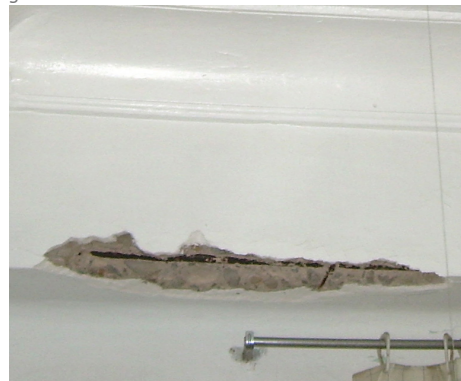
Figura 34. Patología de corrosión. Viga de baño en vivienda puerta número 5.
