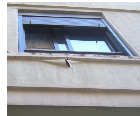
Figura 17. Patologías de pérdida de cohesión y lavado diferencial sucio. Paramento bajo vierteaguas.
