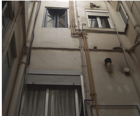
Figura 21. Patología de lavado diferencial sucio. Patio interior izquierdo.
