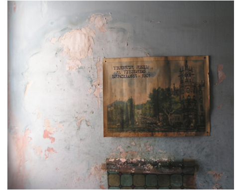
Figura 29. Patología por fuga. Tabiquería interior.
