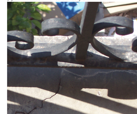
Figura 19. Patologías de corrosión. Barandilla de protección de balcones y miradores.
