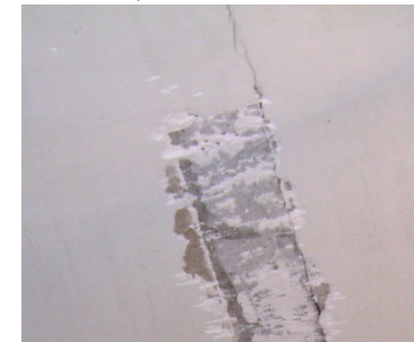
Figura 37. Patología de grietas y fisuras. Dormitorio vivienda de portería.
