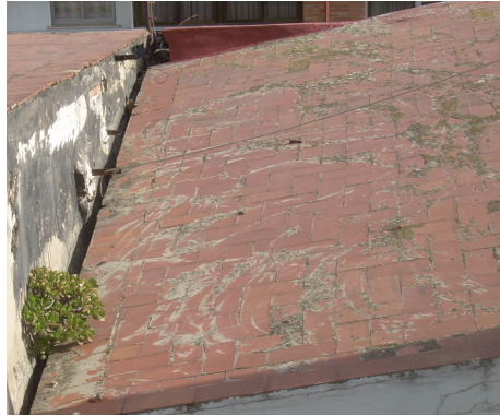
Figura 26. Patología de microorganismos y vegetación. Cubierta inclinada a orientación norte.
