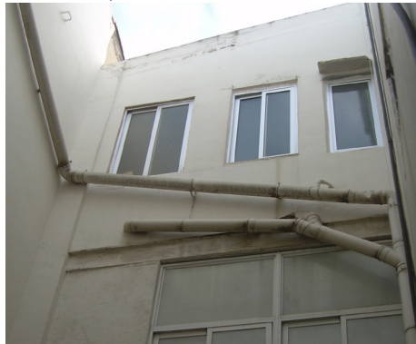
Figura 22. Patología de lavado diferencial sucio. Patio interior galerías.
