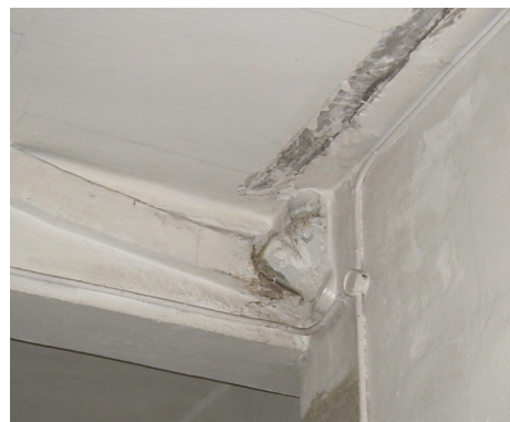
Figura 33. Patologías de humedades, fisuración y grietas. Local taller.
