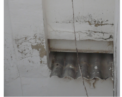
Figura 23. Patologías de pérdida de cohesión, grietas y fisuras. Coronación patio interior.
