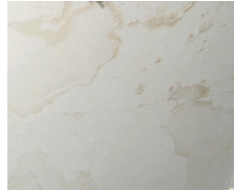
Figura 30. Patología por fuga. Techo baño vivienda.
