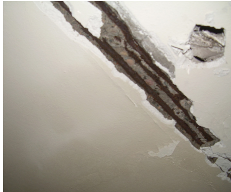
Figura 39. Patologías de corrosión y desprendimiento de hormigón. Vivienda puerta número 4.
