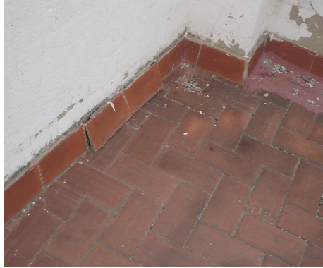
Figura 28. Patologías de desprendimiento del solado y deterioro de las juntas. Cubierta comunitaria.
