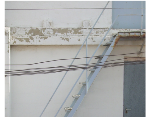
Figura 24. Patologías de pérdida de cohesión, grietas y fisuración. Casetón de cubierta.
