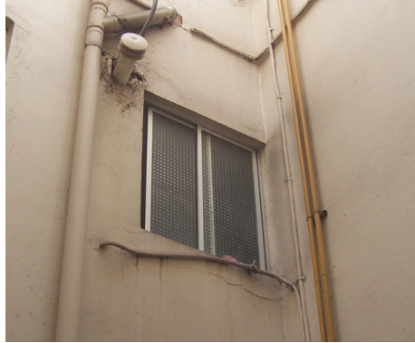
Figura 20. Patología de suciedad, grietas y fisuras. Patio interior derecha.
