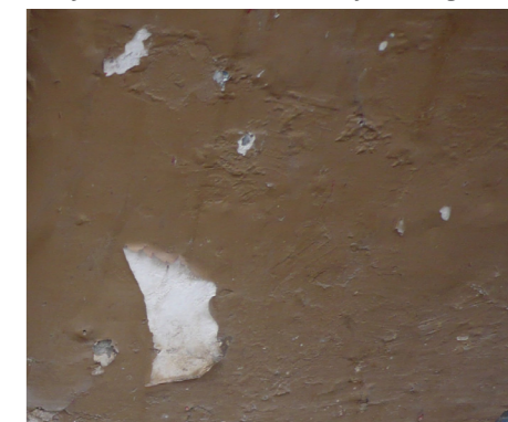
Figura 18. Patologías de pérdida de cohesión, grietas y fisuras. Basamento del edificio.
