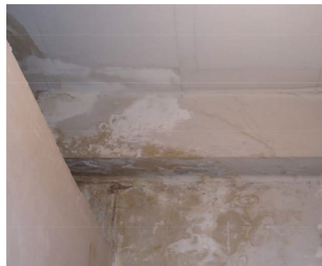
Figura 32. Patología de humedades. Local de oficinas.
