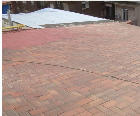
Figura 27. Patología de desprendimiento, rotura del solado y deterioro de las juntas. Cubierta inclinada.
