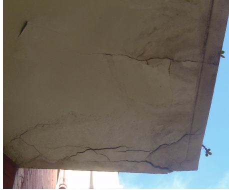
Figura 38. Patología por grietas y fisuras. Mirador vivienda puerta número 3.
