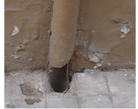
Figura 31. Patología por rotura. Bajante de pluviales en fachada principal.
