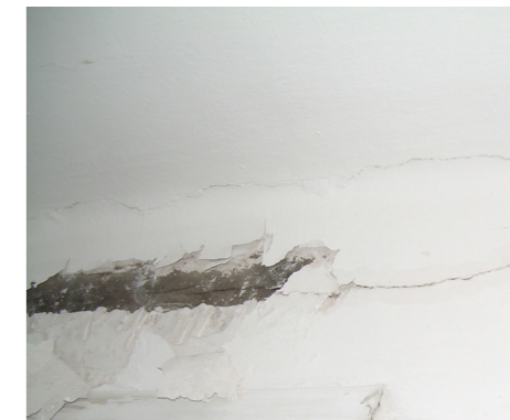
Figura 35. Patología por grietas y fisuras en viga. Cocina vivienda puerta número 19.
