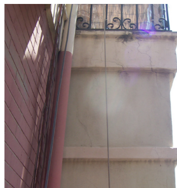
Figura 15. Patologías de suciedad, grietas y fisuras. Paramentos verticales de fachada.
