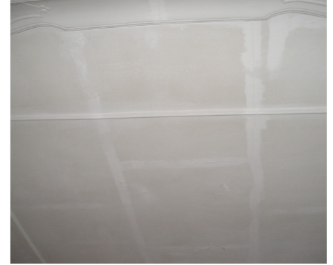
Figura 41. Patología de grietas y fisuras. Dormitorio vivienda puerta número 11.
