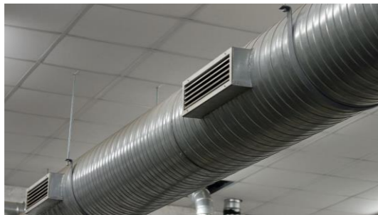
Conductos de climatización sobre falsos techos de listones.
