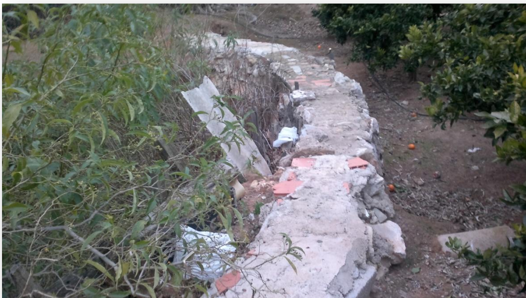
Foto2.- Muro artificial para contención de la parcela agrícola que está junto al ullal
