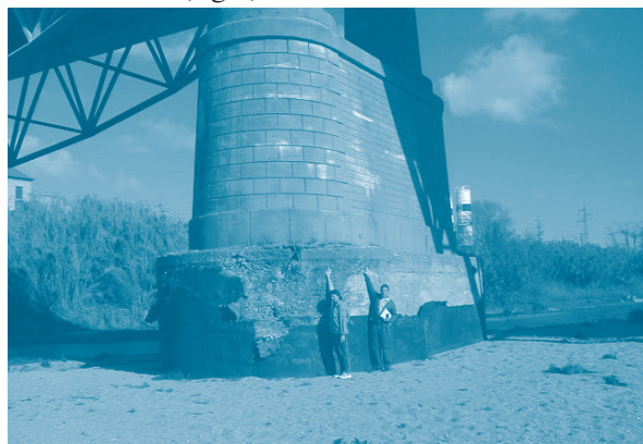
Figura 6. Erosión general del cauce aluvial en una de las pilas del puente de la carretera N-II entre los núcleos de Malgrat de Mar y de Blanes (2002).
