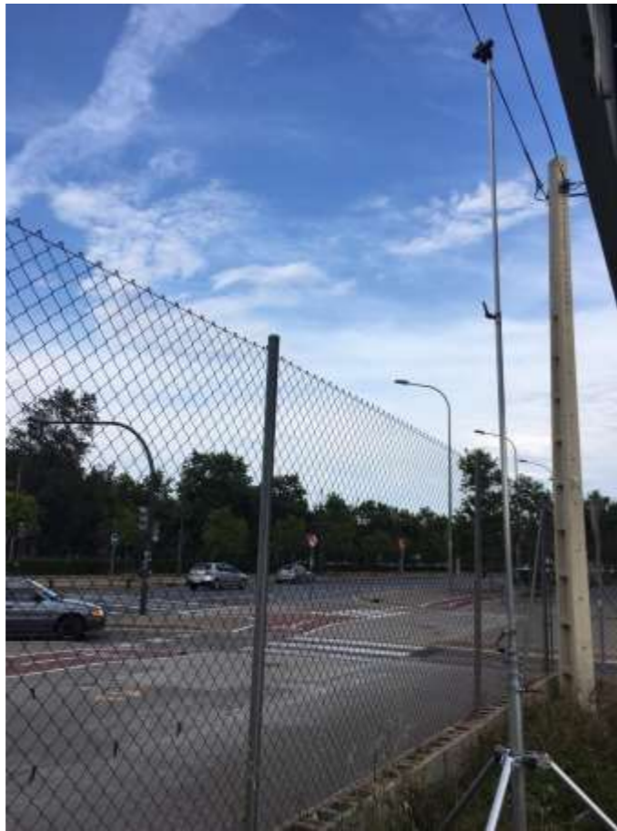
Figura 38. Mástil utilizado para colocar las cámaras. Fuente: Elaboración propia
