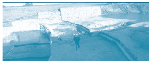
Figura 16. Zona de falla.
