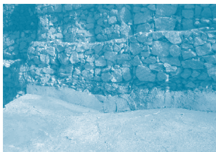
Figura 15. Deformaciones de los muros de gaviones.
