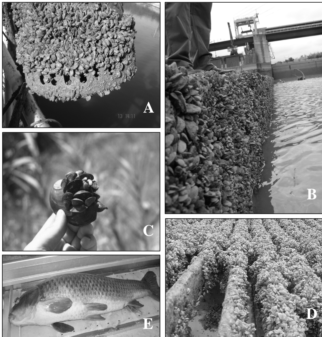
Figura 3. Efectos del mejillón cebra sobre distintas obras e infraestructuras en la Cuenca del Ebro, así como sobre especies acuáticas. (A) Captación de la Estación de Alerta de la CHE en Cabriana; (B) Embalse de Puente Larra; (C) Ejemplar de Anodonta "colonizado" de mejillón cebra; (D) Rejas de la central hidroeléctrica de Ribarroja, en el embalse del mismo nombre; (E) ejemplar de carpa muerto por infección de las vías urinarias con un parásito de peces ( Phyllodistomum folium ; Helminto) introducido por el mejillón cebra
