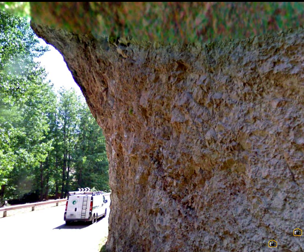
En las dolomías/calizas dolomíticas del Senoniense, Cretácico Sup. NW de El Campo. Protección frente a las caídas de bloques. SE de Hoja de Terriente.
