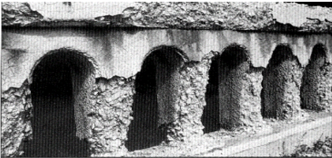
Figura 4. Deterioro debido a los ciclos hielo-deshielo (Experts, 2006).
