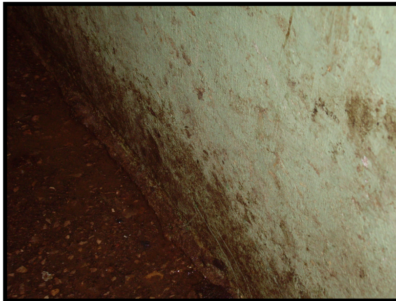
Fig. 31: Suciedad en paredes de cuadra de estabulación. Fuente: Propia.
