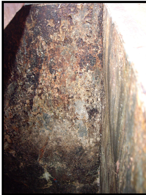
Fig. 29: Mal estado de conservación contenedores de subproductos.
