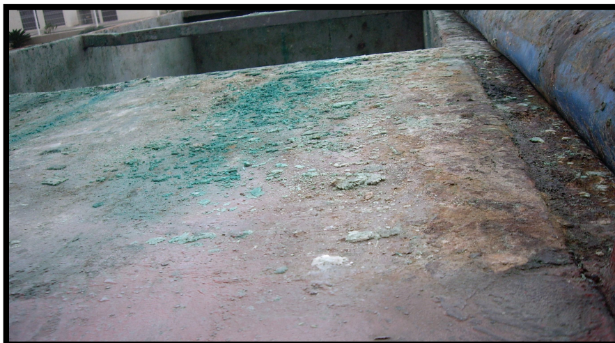
Fig. 30: Suciedad en contenedor de subproductos.
