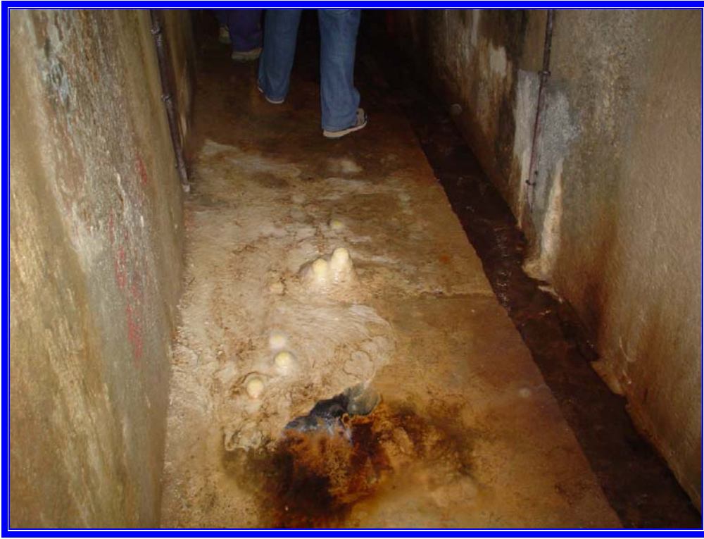
Fotografía 14 : Restos calcáreos debido a filtraciones
