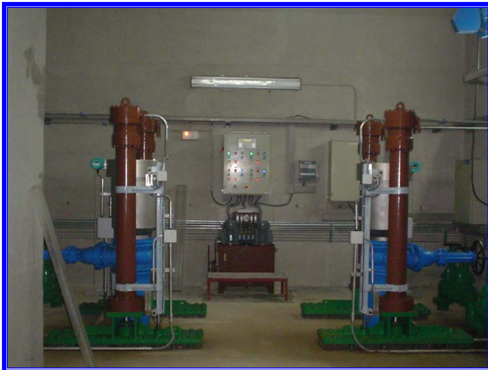
Fotografía 8 : Sala de Válvulas
