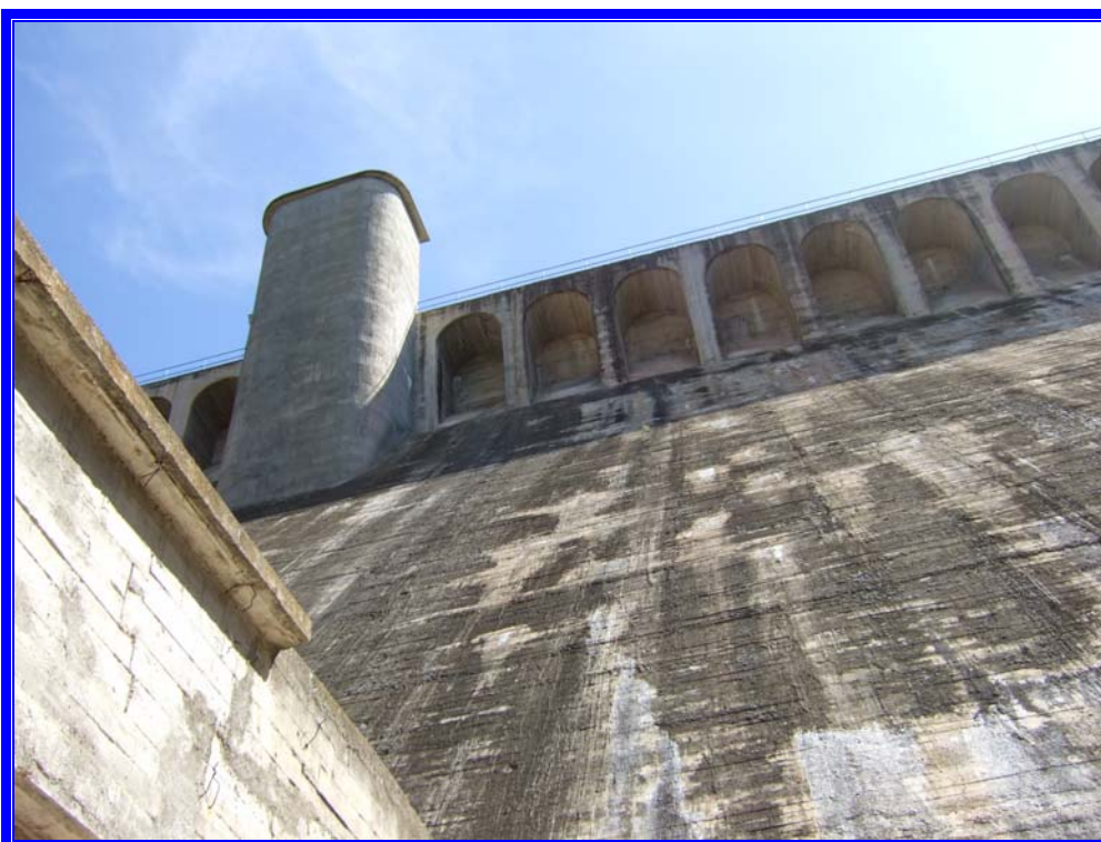
Fotografía 9 : Vista frontal desde pie de presa, se observan zonas húmedas
