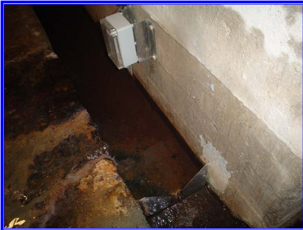
Fotografía 18 : Aforador tipo Thomson
