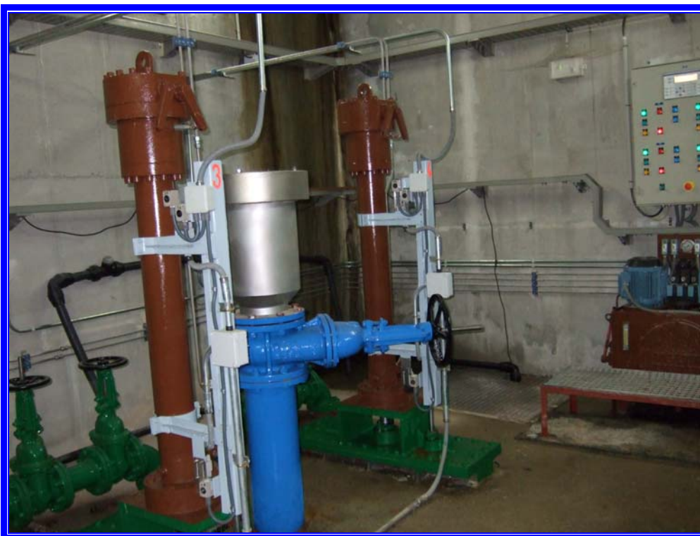
Fotografía 9 : Sala de válvulas
