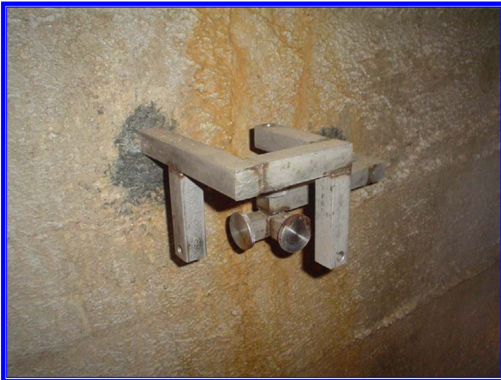
Fotografía 16 : Medidor de apertura de juntas
