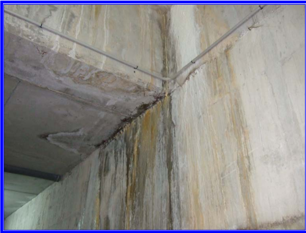
Fotografía 11 : Filtraciones internas en cuerpo de presa
