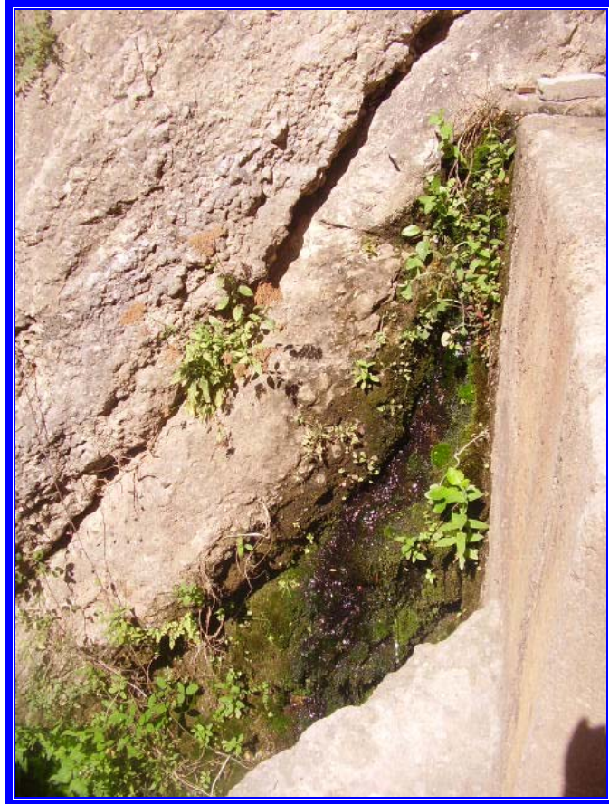
Fotografía 11 : Filtración localizada en la roca del estribo derecho.
