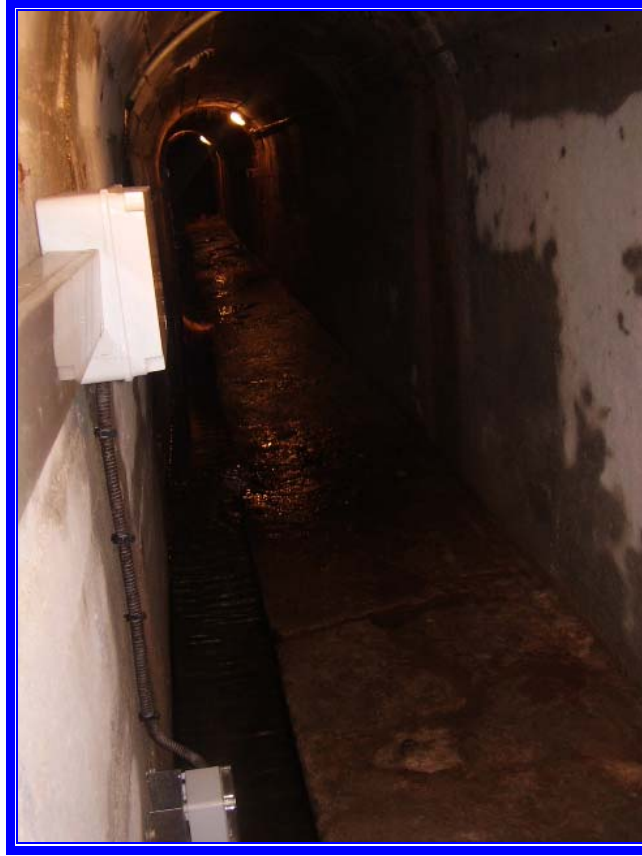
Fotografía 15 : Galería inferior completamente húmeda debido a las filtraciones
