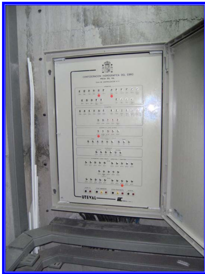
Fotografía 23: Caja de centralización.
