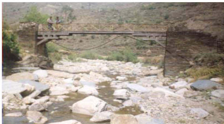
Figura 37. Puente de vigas de madera con vigas voladizas empotradas en los estribos de 15 mts X 1 mts de ancho de uso peatonal. Nepal. www.bridgetoprosperty.org
