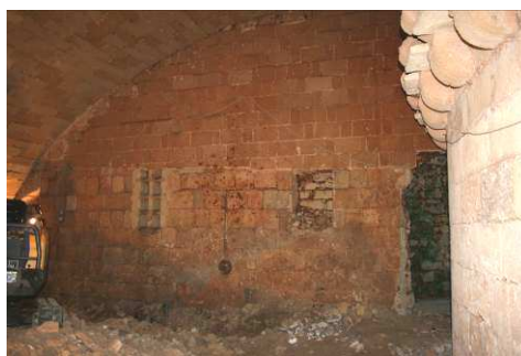
Fig. 8. Cortina muraria posta ad ovest. In evidenza l'archibugiera a foro tondo con lunga fessura verticale e la traccia della merlatura che coronava la struttura difensiva prima di essere sopraelevata alla fine del XV secolo.
