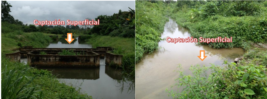
Figura 4 Captación Superficial en el rio Blanco
