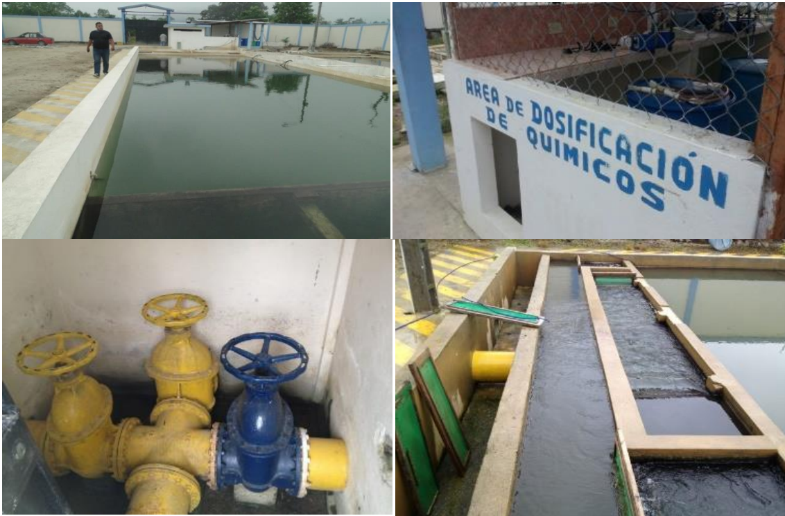
Figura 6 Planta de potabilización
