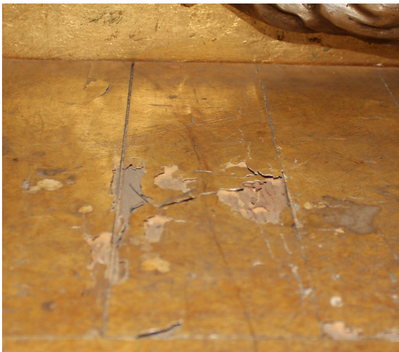
Fig. 16 Daños causados por insectos xilófagos
