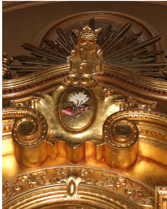
Fig. 20 Grietas en la parte superior
