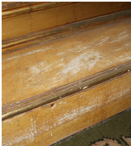
Fig. 19 Arañazos en la parte baja
