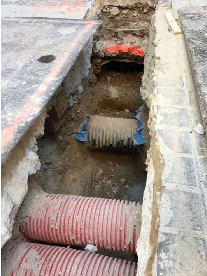
Ilustración 28. Paso de canalizaciones a pie del edificio.
