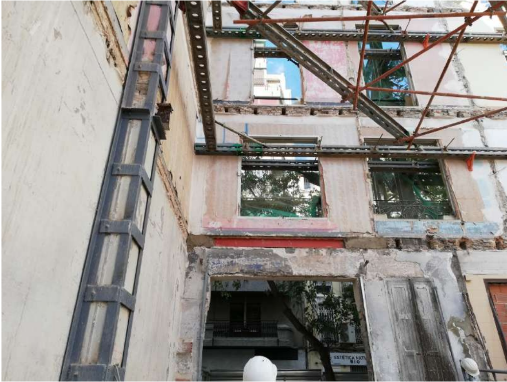
Ilustración 48. Colocación de dos IPN a modo de dintel en el acceso principal a la obra.
