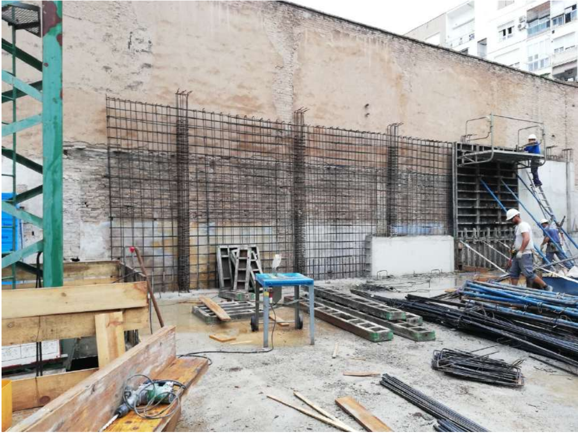
Ilustración 127. Formación de los muro perimetral medianero con el cine sobre forjado del aparcamiento.
