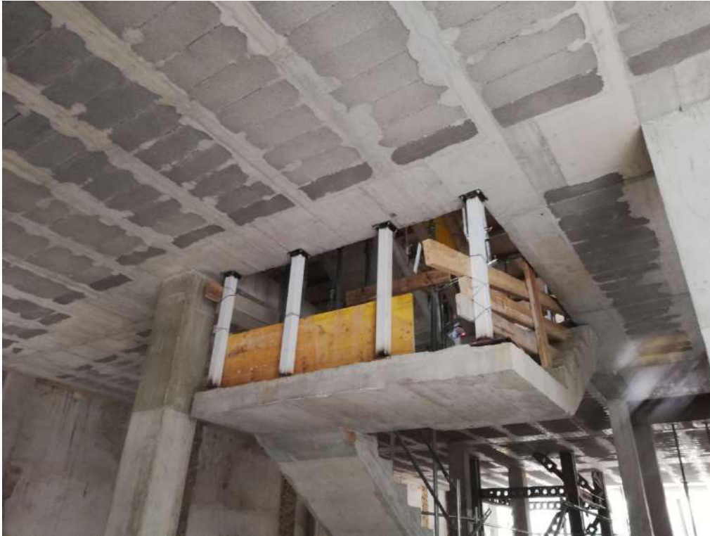
Ilustración 155. Refuerzo de sustentación de descansillo de escalera.
