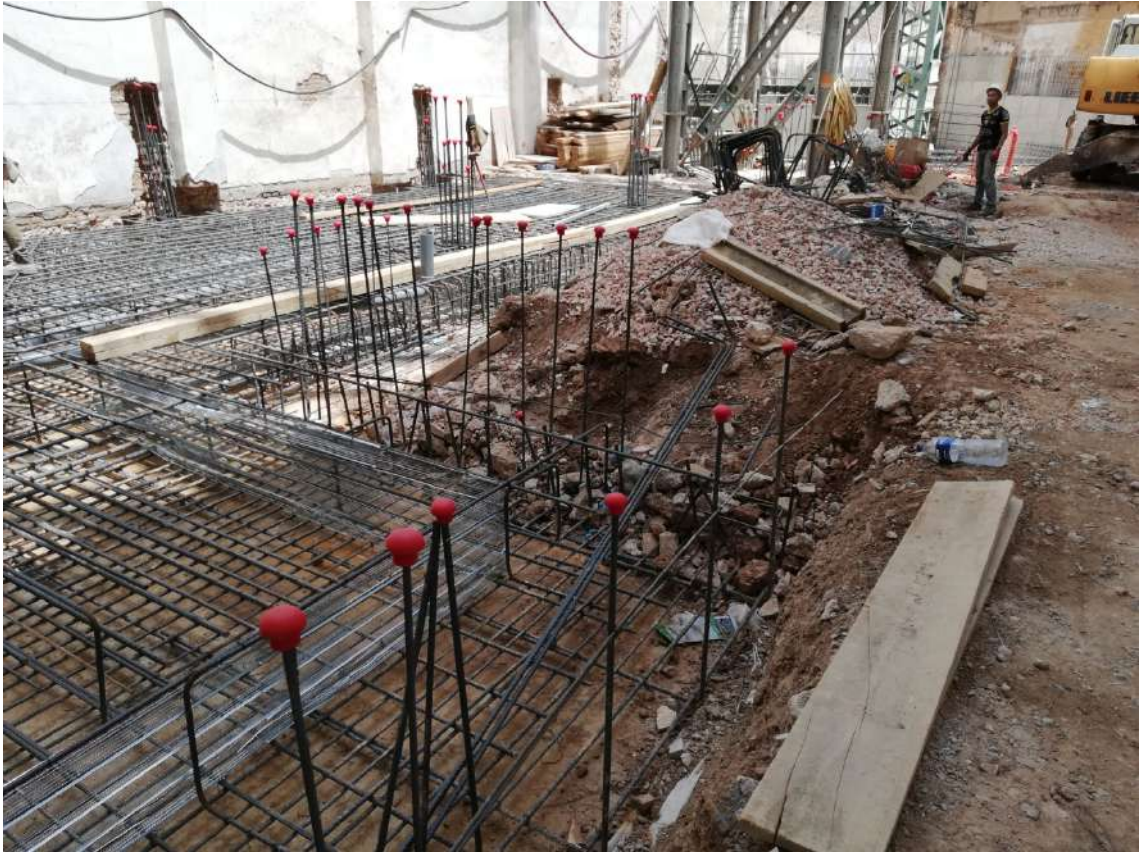
Ilustración 90. Setas sobre todas las armaduras sobresalientes.
