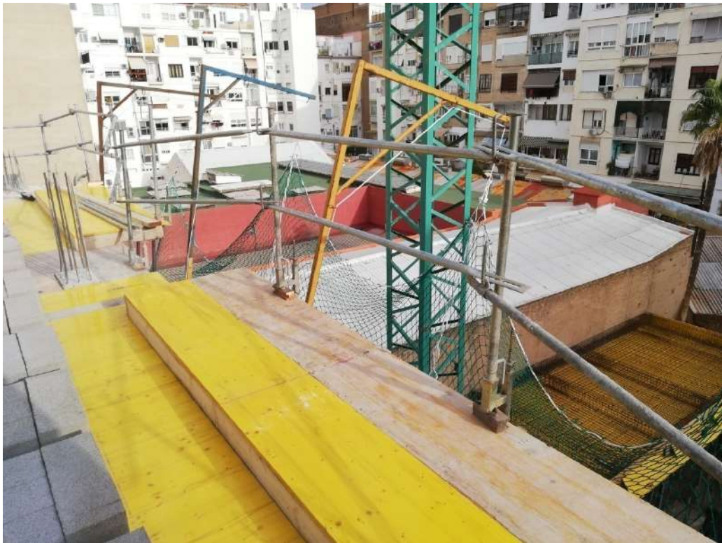
Ilustración 164. Protecciones de borde insuficientes.
