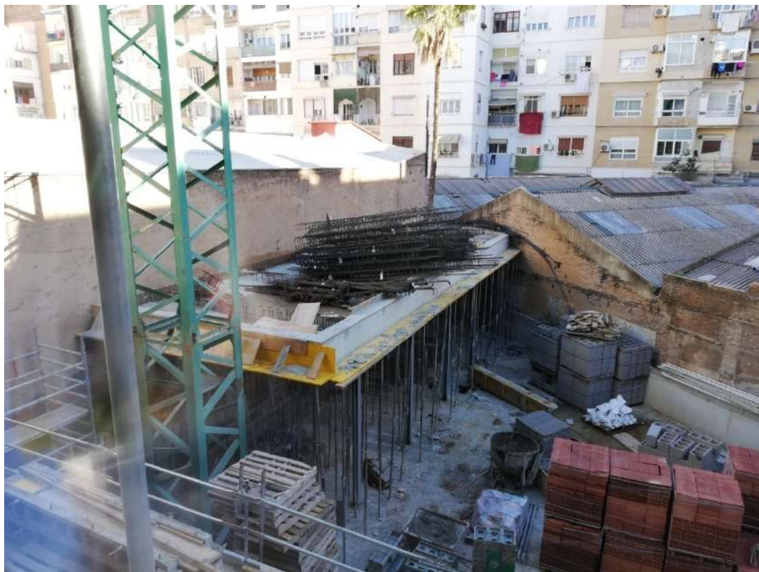
Ilustración 171. Acopio de armado excesivo sobre cubierta de la piscina.
