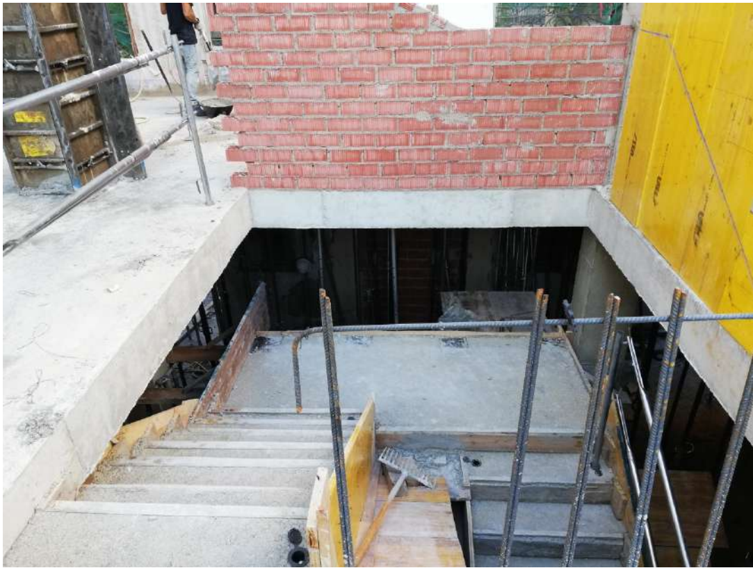
Ilustración 144. Tramo de escalera a planta primera ya ejecutado y replanteo del siguiente.
