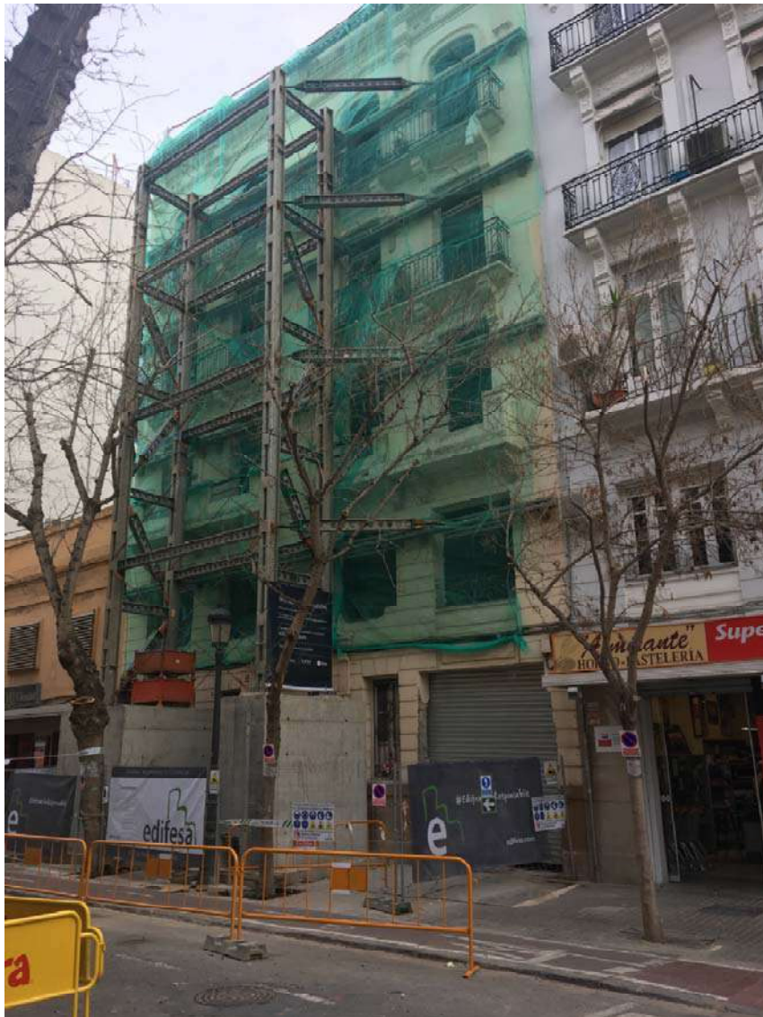
Ilustración 9. Red de protección en fachada principal.
