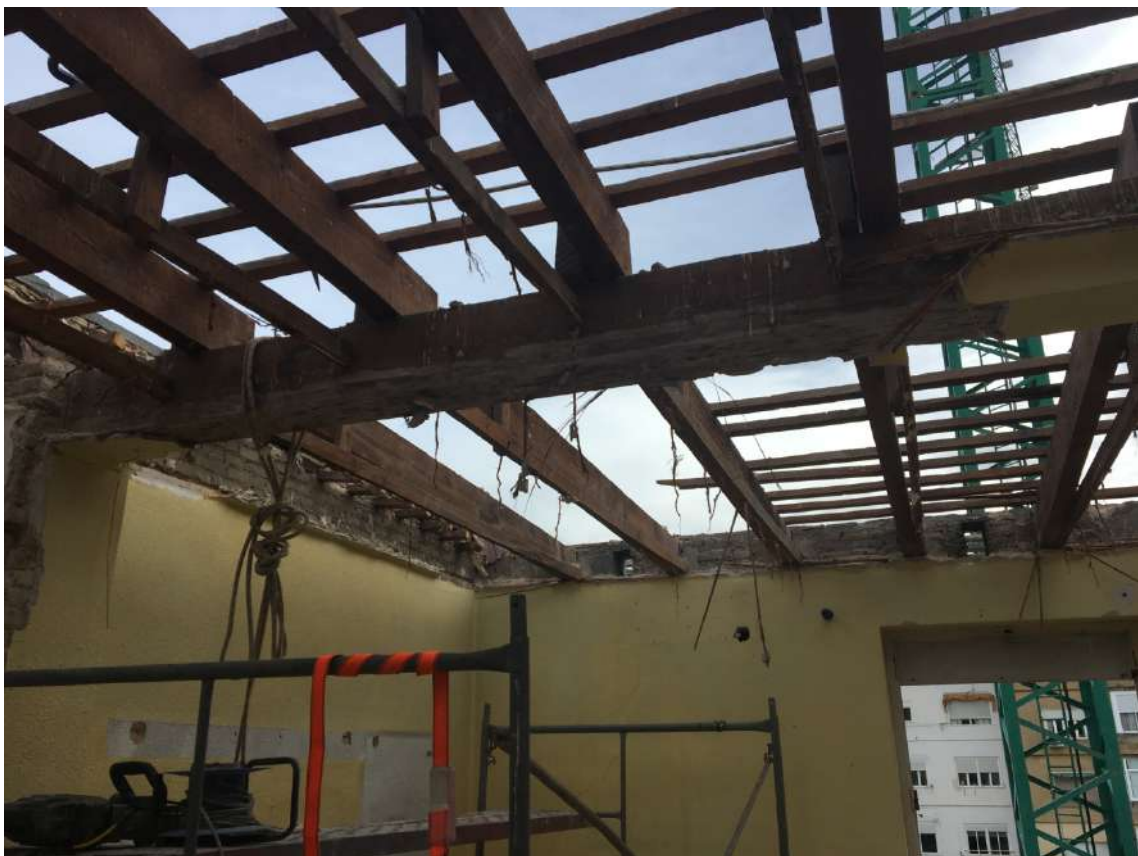
Ilustración 11. Estructura de madera vista tras los trabajos de demolición de la cubierta.
