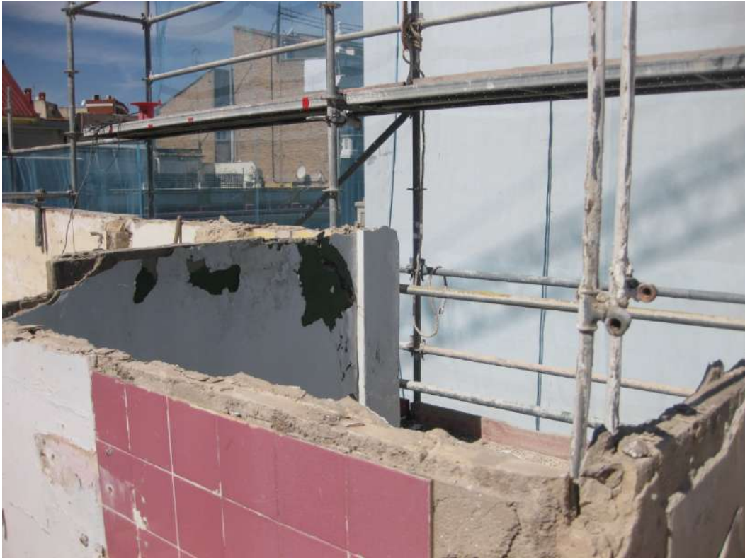
Ilustración 14. Parte superior de fachada de patio interior derribada.
