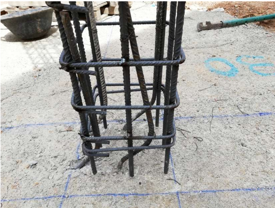
Ilustración 98. Armadura de espera descentrada.
