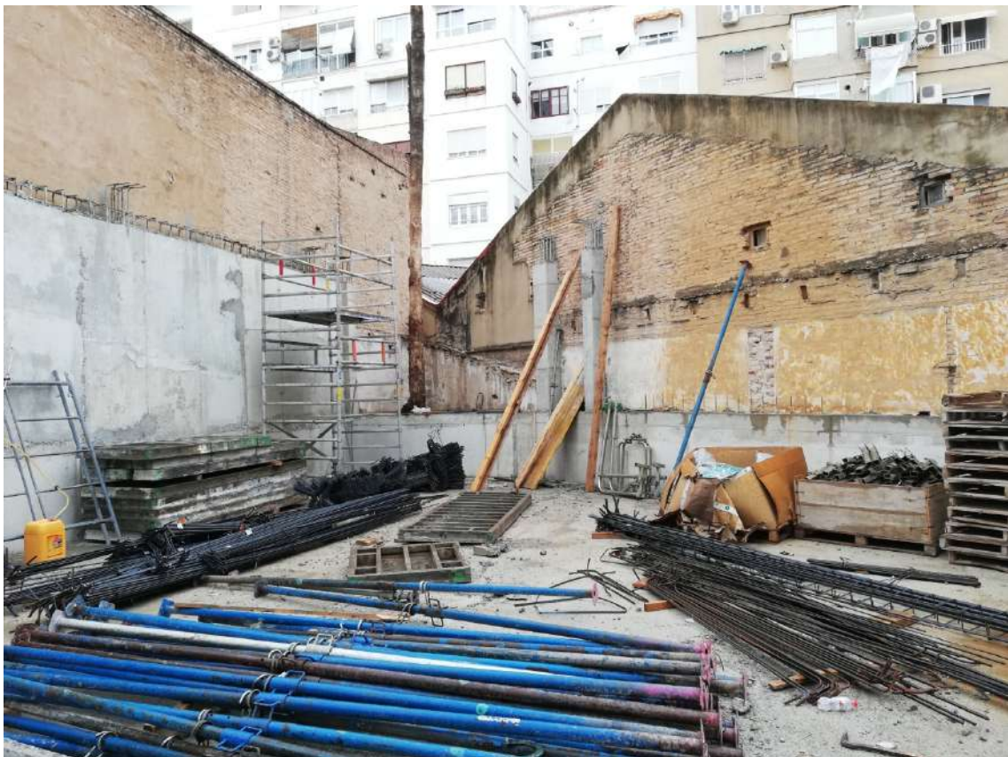
Ilustración 137. Acopio de material sobre forjado del aparcamiento.
