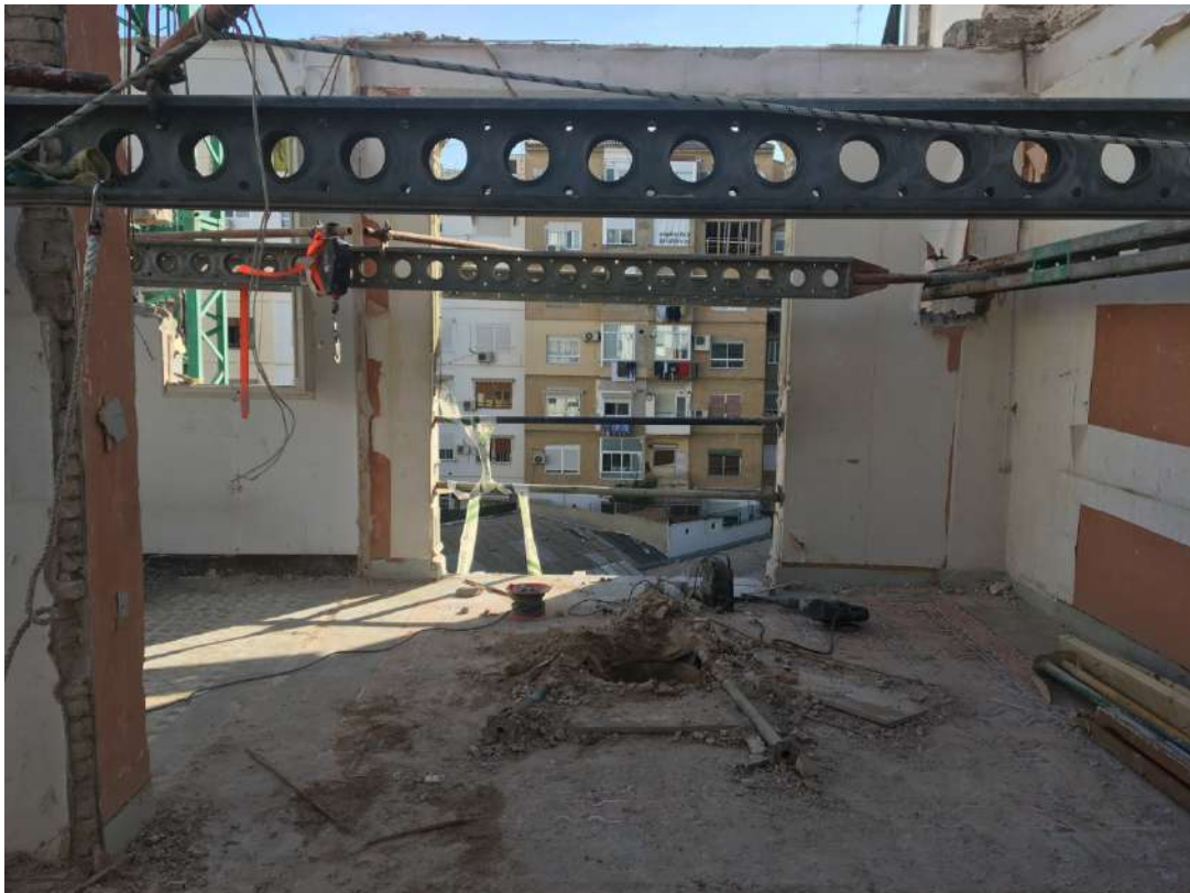
Ilustración 24. Huecos sin señalar ni proteger y bajante de escombros mal instalada.
