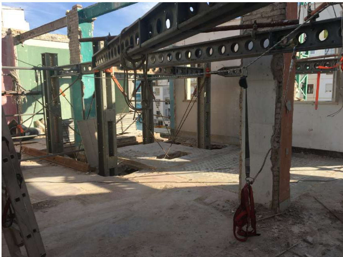
Ilustración 22. Elementos derribados vistos desde forjado de planta cuarta.
