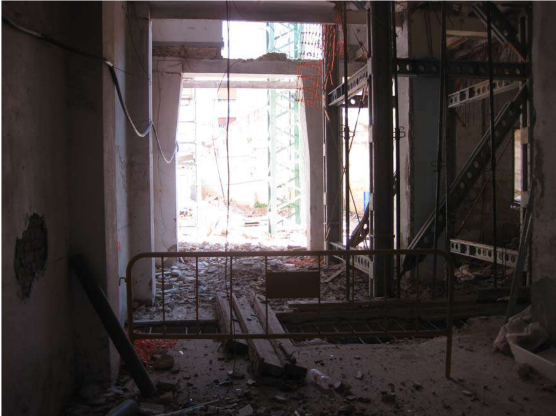
Ilustración 11.1. Acumulación escombros en planta baja.
