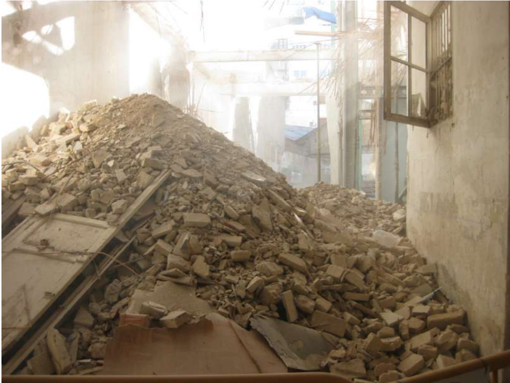
Ilustración 34. Acumulación de escombros en planta baja.
