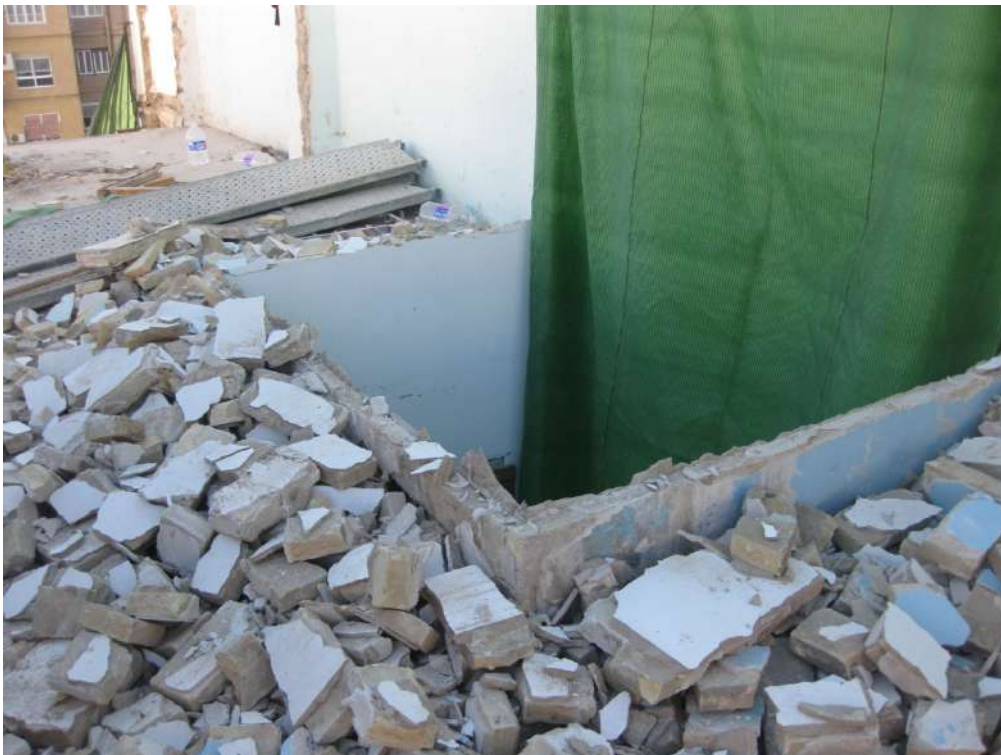
Ilustración 17. Escombro acumulado en forjado de planta quinta.
