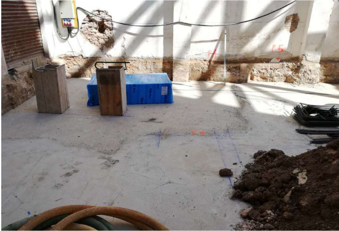
Ilustración 80. Replanteo de pilares y arquetas de registro sobre hormigón de limpieza de losa de cimentación.
