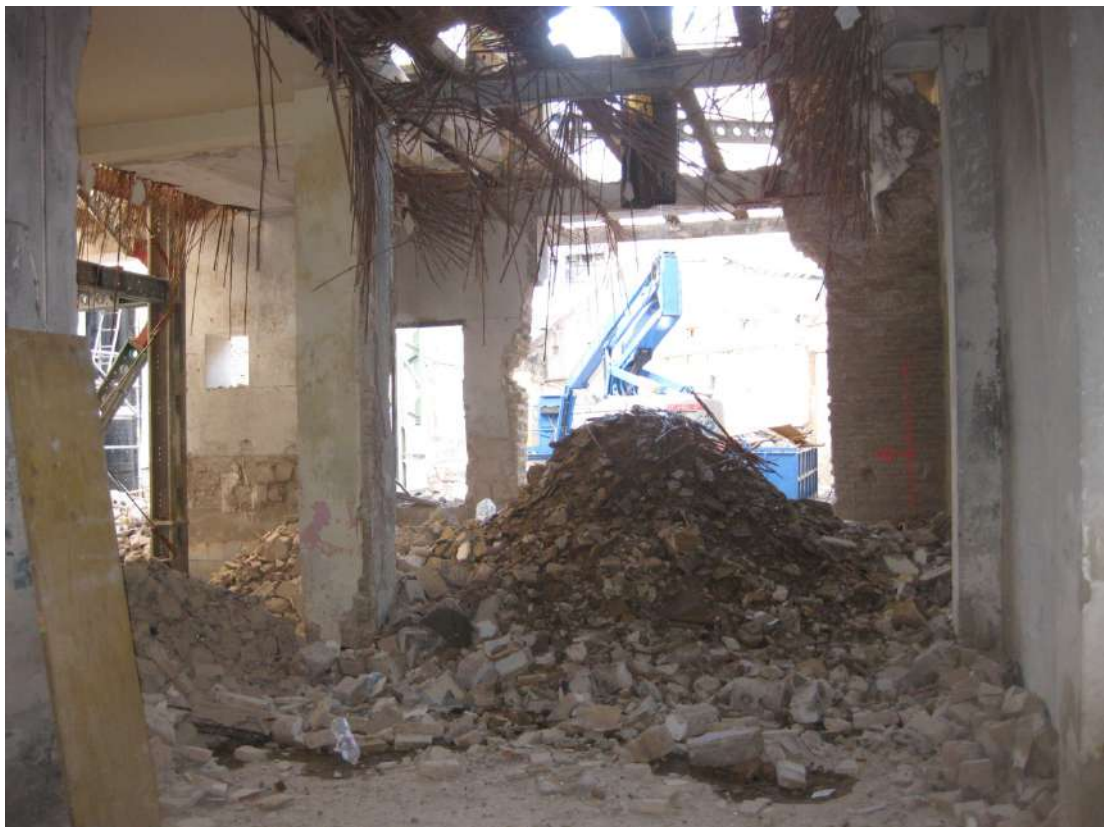
Ilustración 19. Acumulación de escombros en planta baja.
