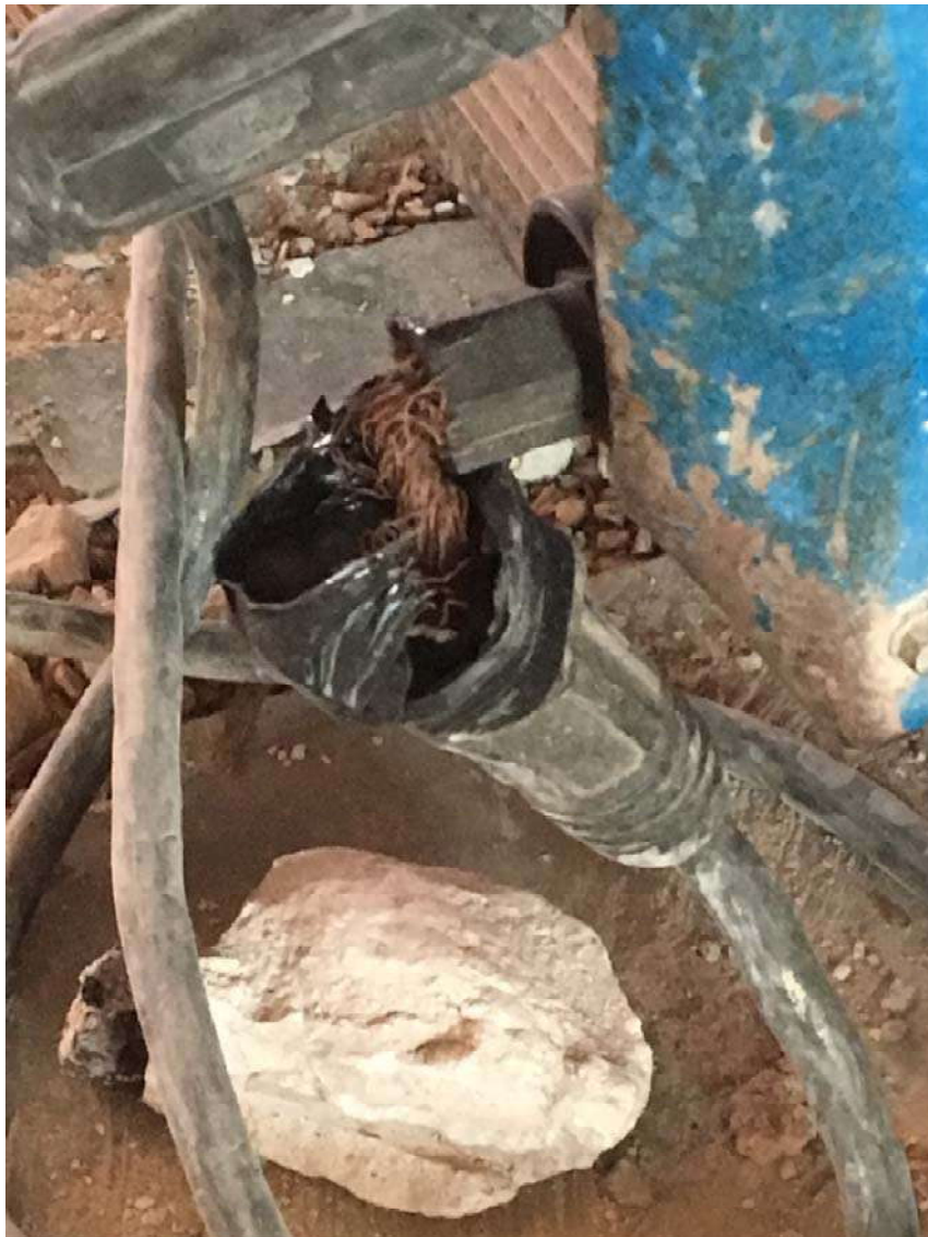
Ilustración 6. Conexiones del cableado del generador en mal estado.
