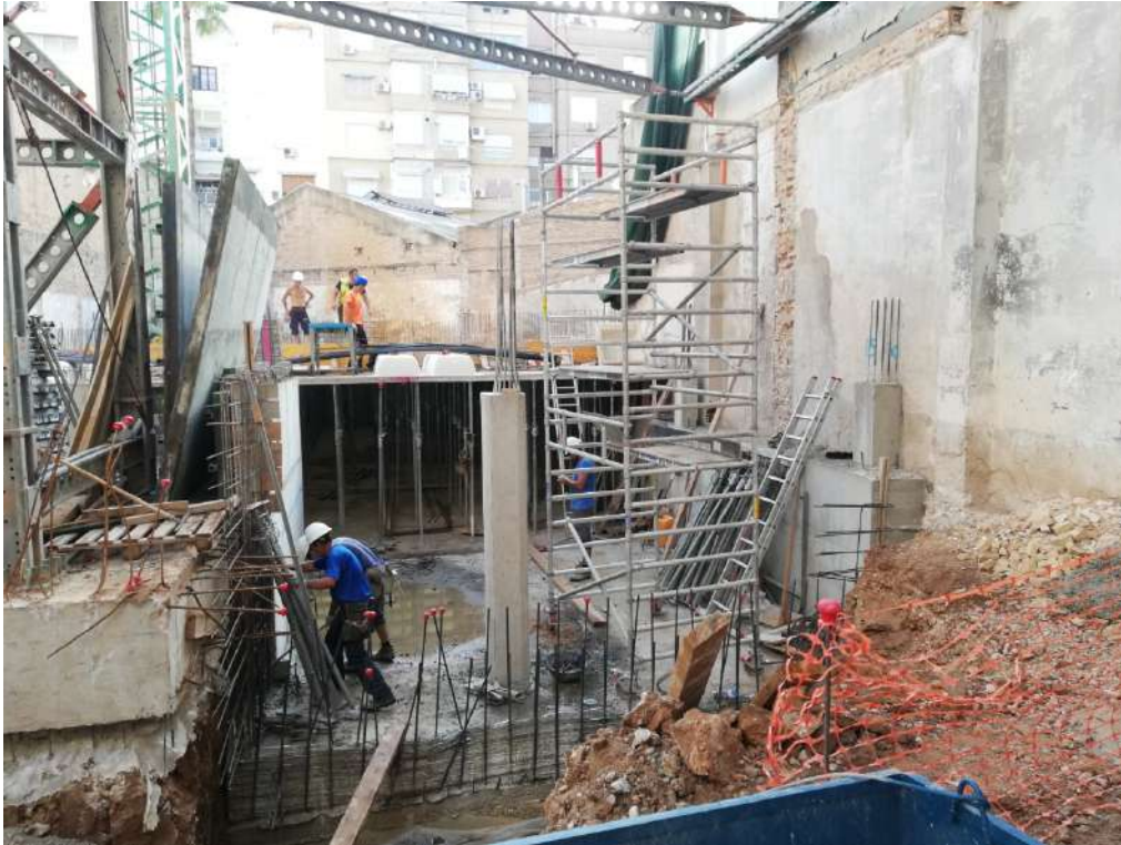
Ilustración 118. Losa de cimentación ya hormigonada y desencofrado de muro medianero con edificio anexo.
