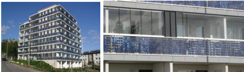
Figura 5.-Paneles fotovoltaicos integrados.
