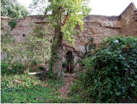
Fig. 2. Aspecto de la zona más deteriorada. Tronera 5 y salida del agua. Encuentro de la cortina con el flanco (Francisco Javier López Martínez, 2013).
