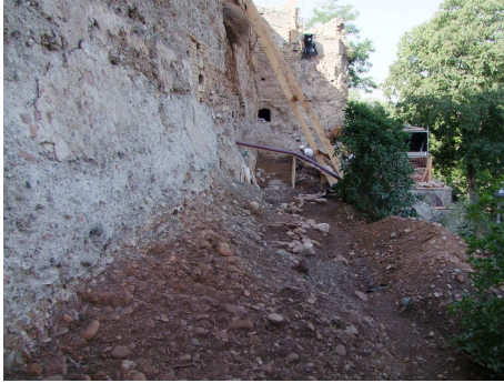
Fig. 4. Aspecto de la zona exterior con los grandes puntales y la conducción provisional del agua a través de la tronera 5 (Francisco Javier López Martínez, 2018).
