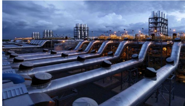
Figura 1.8.. Planta de Generación Eléctrica “Quisqueya II”, con 225 MW de potencia y equipada con 12 motores Wartsila 18V50DF, tiene la capacidad de operar tanto con gas natural como con diésel. Foto obtenida de la página web de Ege Haina
