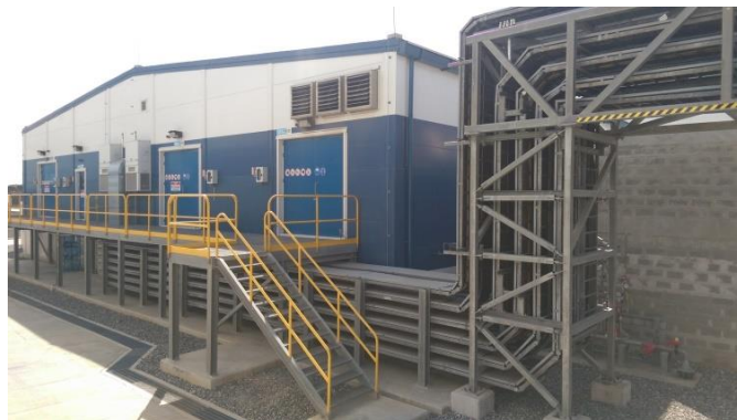
Figura 2.23. Edificio en Quisqueya II en cuyo interior irá el Okken. Foto tomada in situ del punto de conexión de la planta
