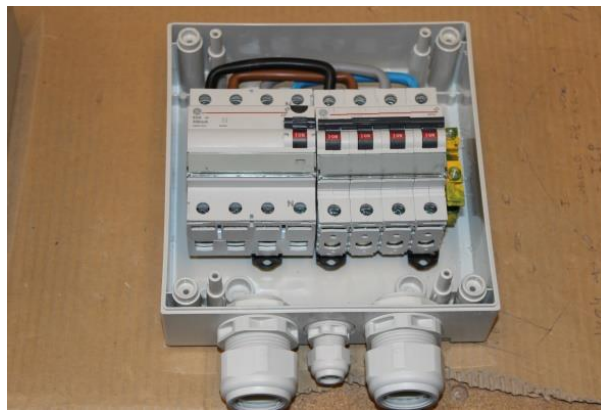
Figura 2.19. Cuadro protección inversor. Foto tomada en instalaciones de Togar
