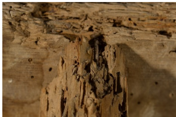
Figura 30. Detalle de la unión entre el travesaño y el paño de la parte superior mediante un clavo.
