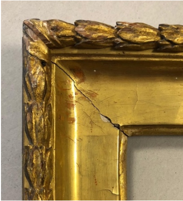
Imagen 78. Grieta que se corresponde con la línea de la junta del ensamble a inglete.
