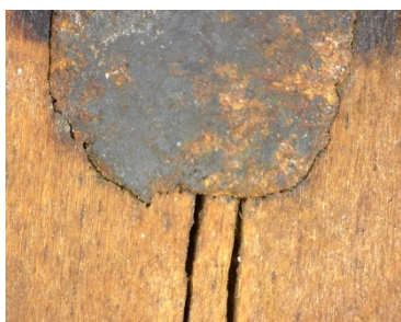
Imagen 69. Macrofotografía del clavo oxidado que ha provocado el agrietamiento en la madera. Realizada con Dinolite a 50X
