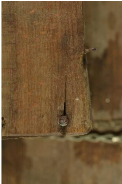
Figura 16. Detalle de la rotura del extremo derecho inferior de la tabla trasera producida por un clavo
