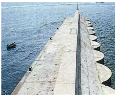
Figura 2.8. Vista superior del dique Duca Degli Abruzzi del Puerto de Nápoles (Italia, 1986)
