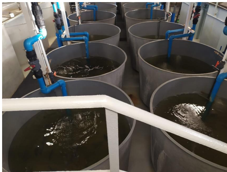
Figure 1.2. Picture of the recirculating aquaculture system (RAS) of the Universitat Politècnica de València.
