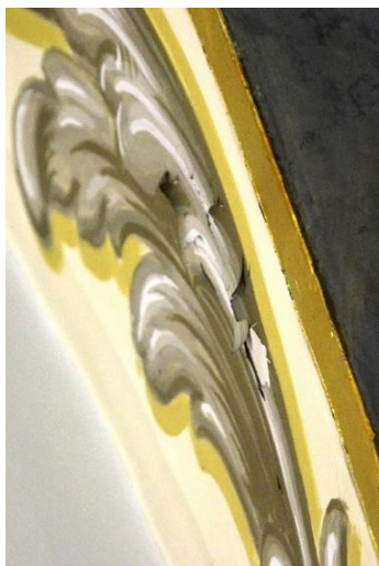
Fig. 35 Grietas en el arco
