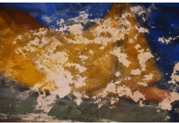
Fig. 40. Cerco de humedad.
