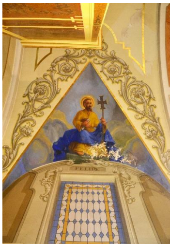
Fig. 44. Daños del luneto de San Felipe
