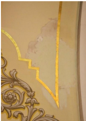
Fig. 33 Decoración de pan de oro y cerco de humedad.
