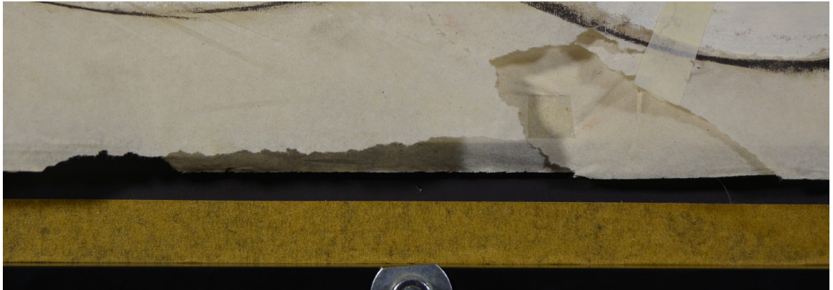
Fig. 24. Detalle de la zona inferior donde se encuentran los dos faltantes de la pieza N°2.
