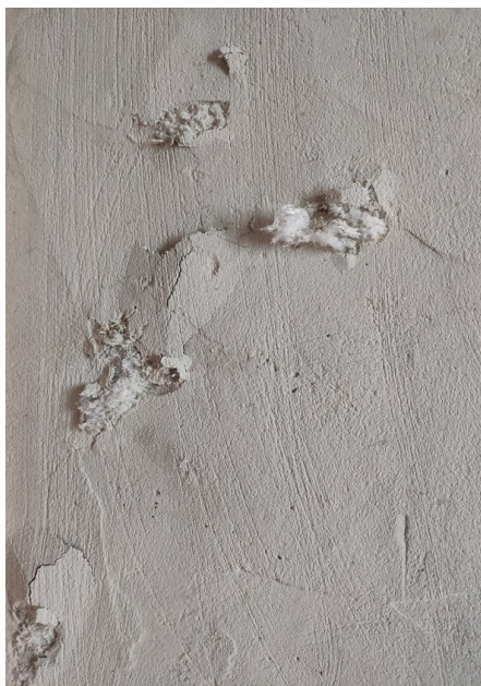
Figura 7 y 8. Eflorescencias salinas de los muros de la parroquia de Algar del Palancia.
