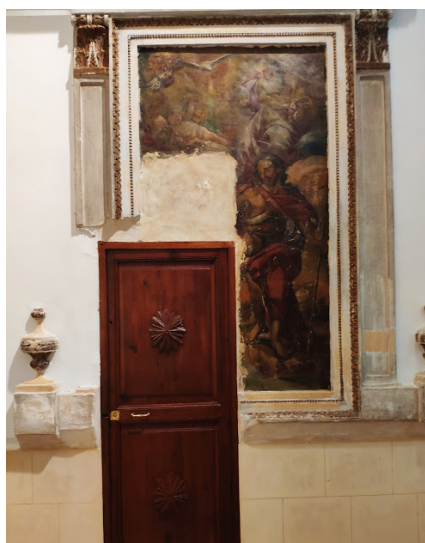
Figura 5. Puerta ubicada dañando la unidad potencial de la obra objeto de estudio.
