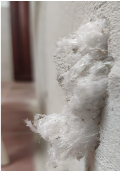
Figura 19. Fotografía de eflorescencias salinas en uno de los muros situados al lado de la obra a estudio.
