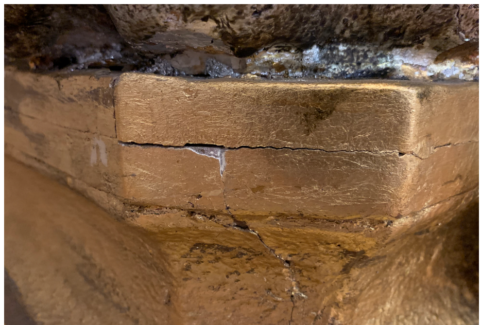
Figura 40. Grietas debidas a los movimientos de la madera
