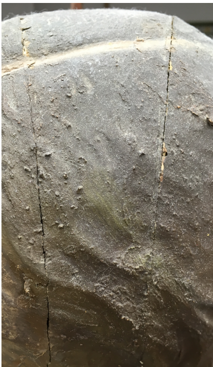
Figura 36. Grieta entre tablones
