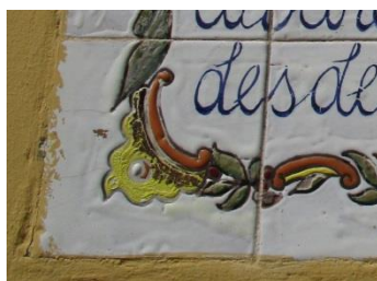
Fig. 46. Defectos de capa blanca estannífera y de policromía.
