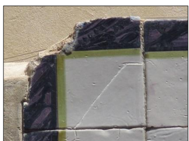
Fig. 125. Detalle del azulejo dañado.
