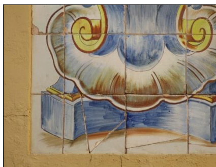
Fig. 90. Azulejos con roturas transversales.
