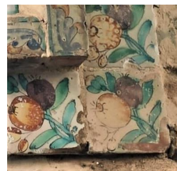
Fig. 37. Picados y desvitrificación con pérdida de lienzo cerámico.
