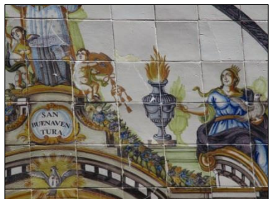
Fig. 126. Relleno defectuoso de faltante con mortero a nivel y entonación del color inadecuada.
