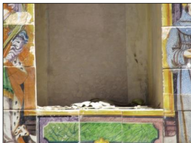
Fig. 131. Suciedad acumulada en el interior de la hornacina.
