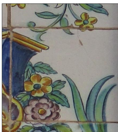
Fig. 97. Fisuras y lascas.
