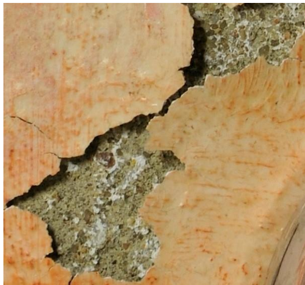
Figura 39. Detalle donde se visualiza la separación de los estratos y sales en el soporte.
