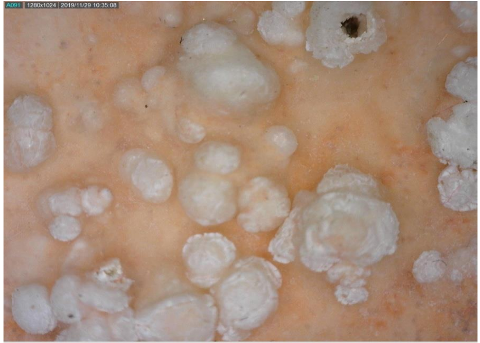
Figura 40. Detalle donde se observa la aparición de sales a través de la pintura. Imagen realizada mediante microscopio digital USB Dino-Lite.
