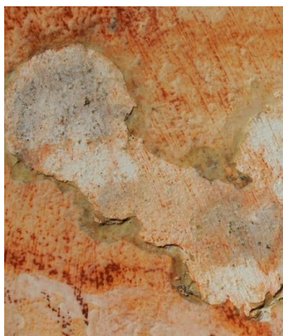
Figura 50. Detalle de la proliferación de microorganismos en algunos faltantes.
