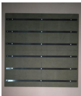
Fig. 34 Panel anclado a la pared
