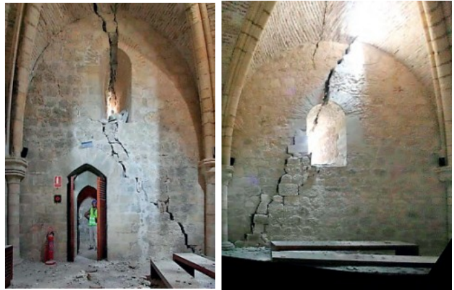
Imágenes interiores tras los terremotos. (Jurado Jiménez, 2011)
