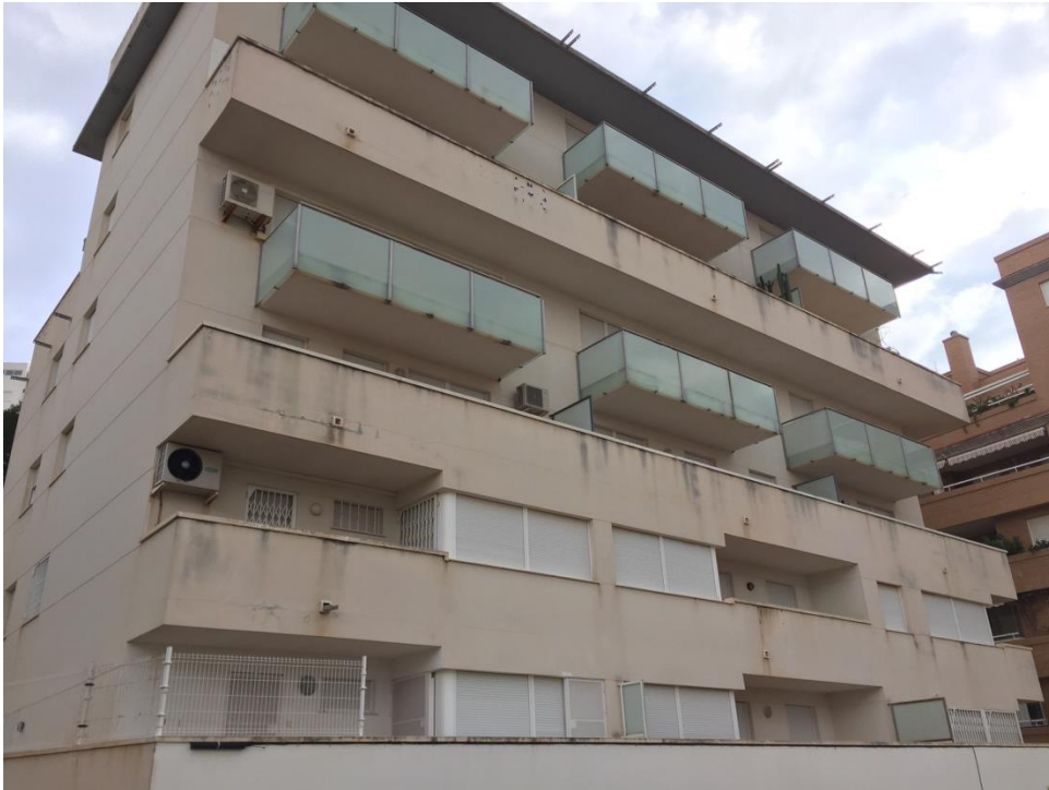
Imagen 33. Patología en fachada. Aparición de manchas en toda la fachada de la vivienda. Fuente: Propia.
