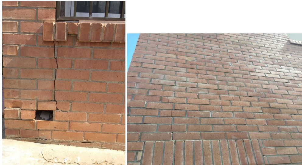
Imagen 32. Patología en revestimiento de fachada, Fisuración de ladrillo en revestimiento. Fuente: Propia.
