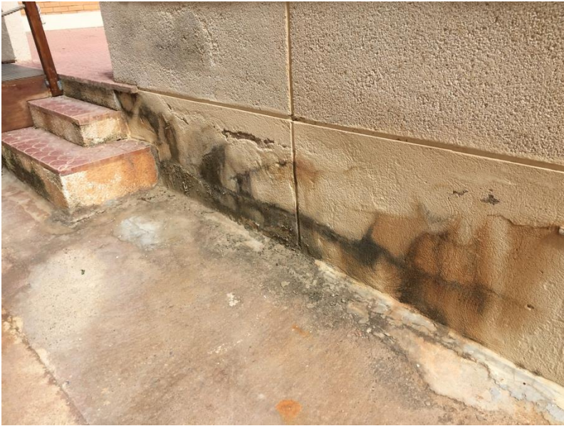
Imagen 31. Patología en fachada, Humedad absorbida del terreno en revestimiento. Fuente: Propia.
