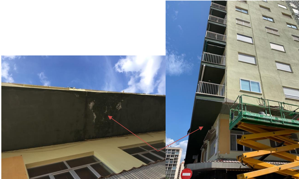
Imagen 20. Edificio con mantenimiento eliminando la efluencia. Fuente: Propia.
