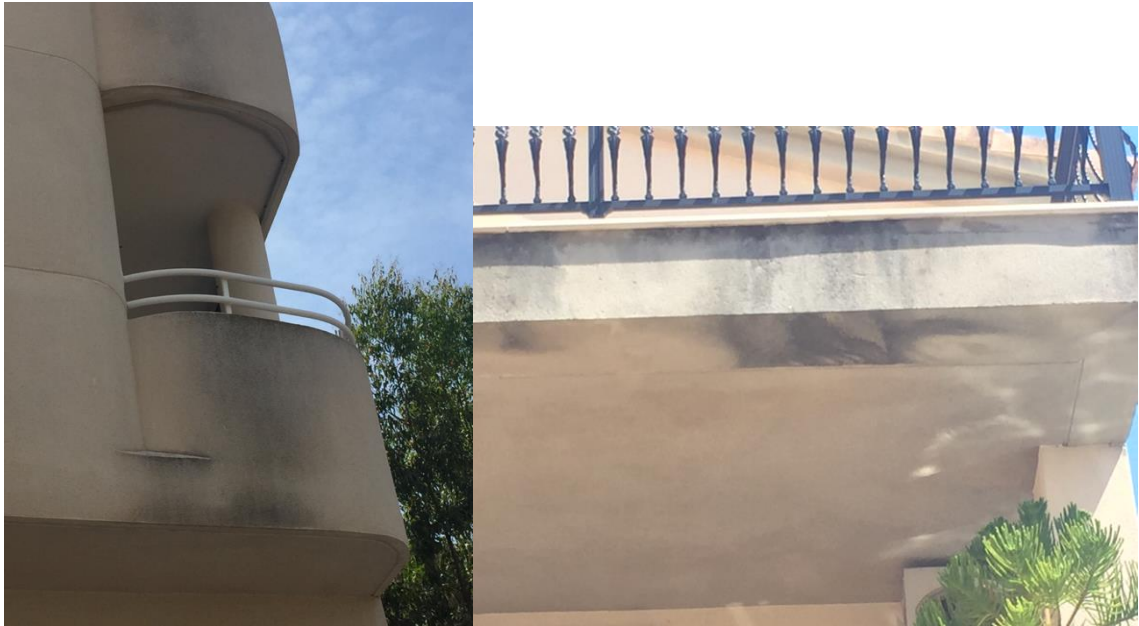
Imagen 18. Edificios con patologías en fachada. Fuente: Propia
