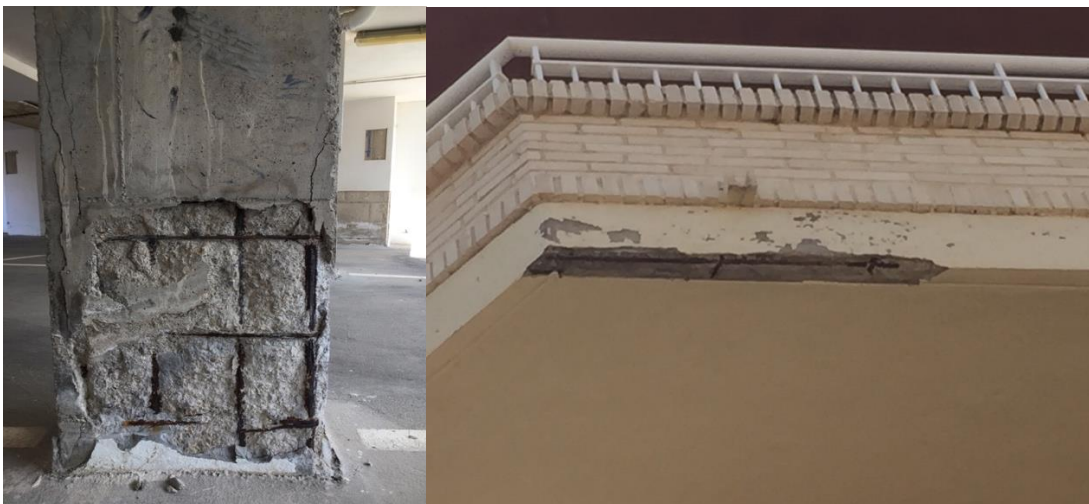
Imagen 30. Patologías en elemento estructural, Pérdida de recubrimiento de armadura. Fuente: Propia
