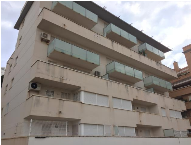
Imagen 17. Edificio con patologías en fachada: Fuente: Propia.
