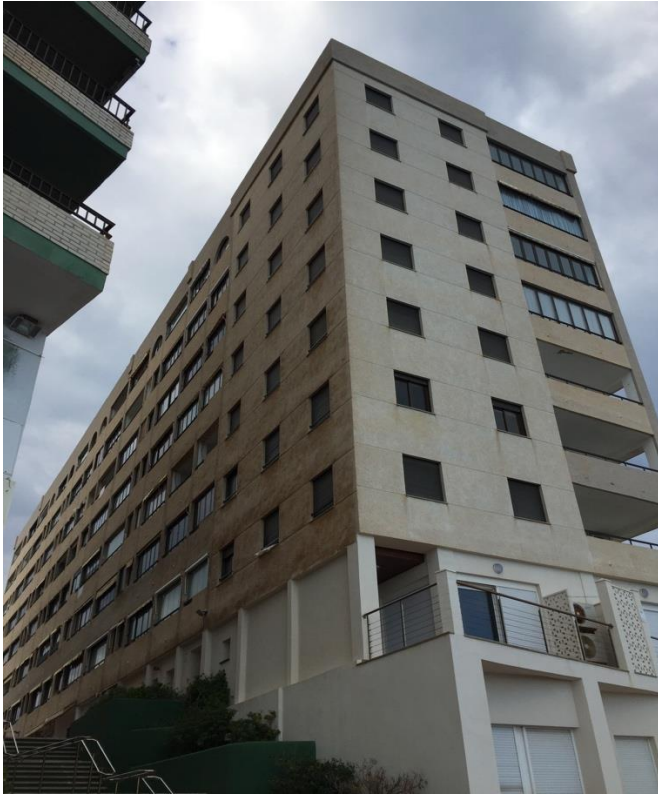
Imagen 6. Edificio con problemas en fachada. Fuente: Propia
