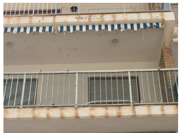
Imagen 19. Edificio con patologías en frente de forjado. Fuente: Propia
