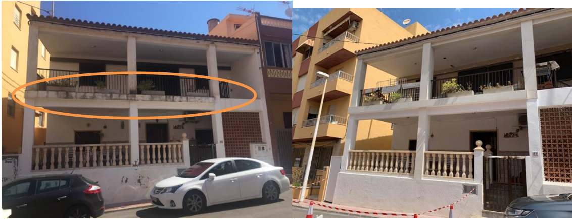
Imagen 26. Edificio con mantenimiento. Revestimiento metálico en frente de forjado para protegerlo de una mayor corrosión. Fuente: Propia.
