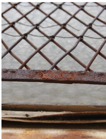
Figura 23. Costra de herrumbre en ensamble del enrejado de los ventanales.
