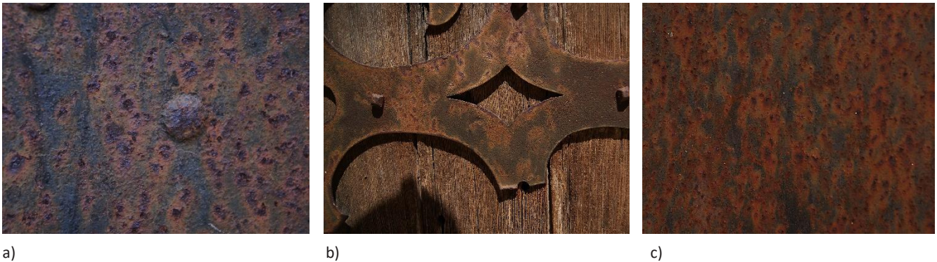
Figura 20 (a-c). Fotografías detalladas de daño por picadura: a) Detalle de daño por picadura en Portón Metálico; b) Daño por picadura en Bisagra; c) Detalle de daño por picadura.
