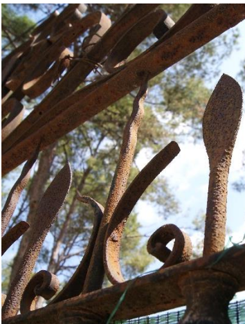
Figura 10. Detalle del estado de conservación del portón principal exterior.
