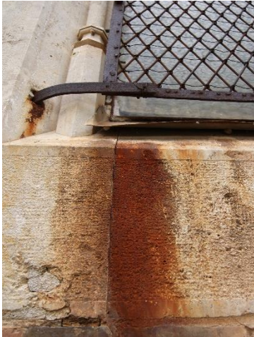
Figura 24. Mancha de herrumbre sobre los muros del panteón del Marqués de Dos Aguas.
