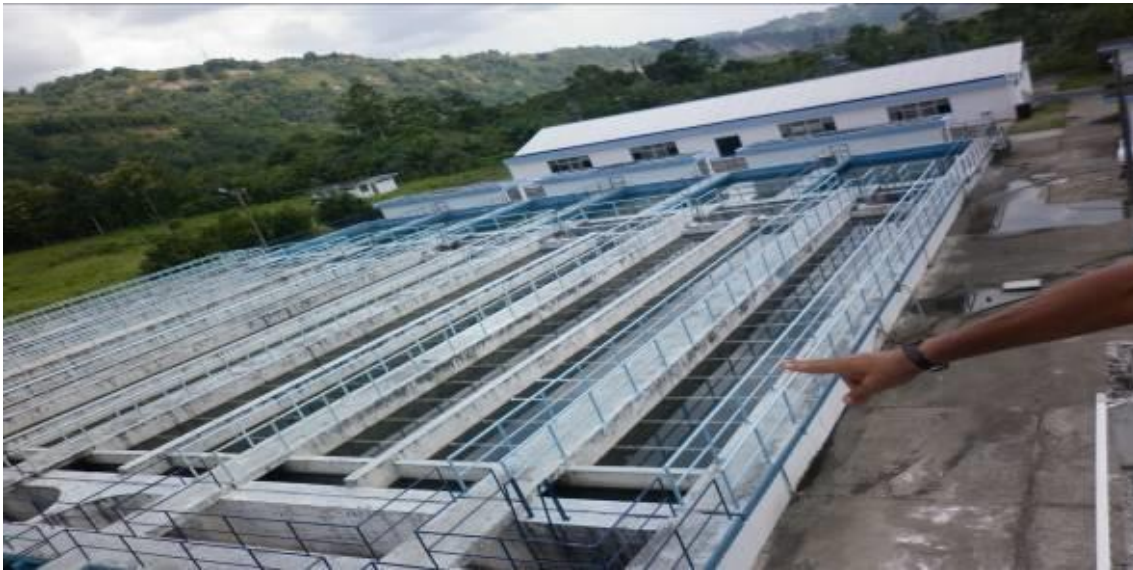
Ilustración 11. Planta de Tratamiento
