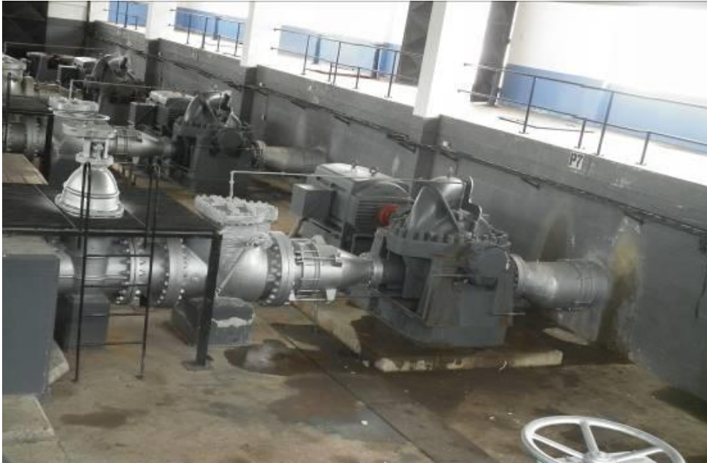
Ilustración 8. Estación de Bombeo de Agua
